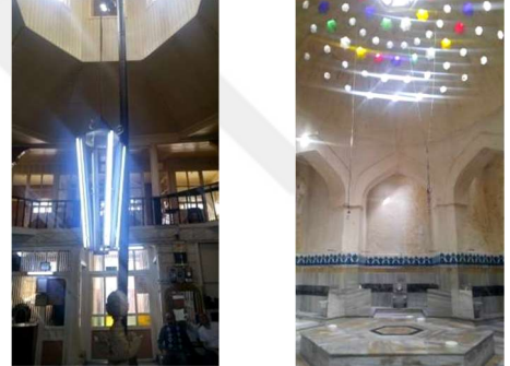
Camekan ve sıcaklık-aydınlatma
