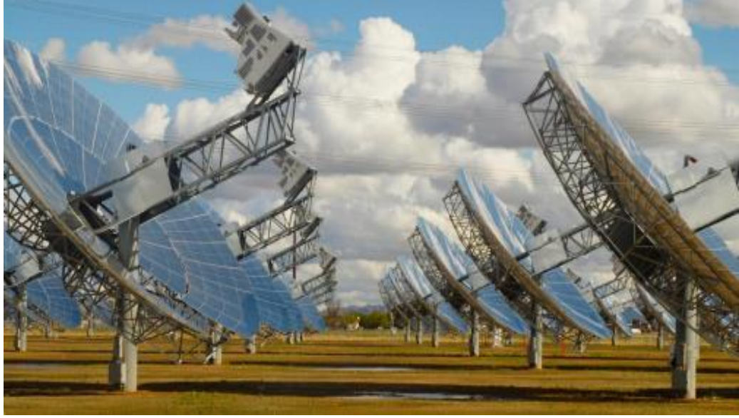
Şekil 2.23 : Parabolik çanak tipi ısı güneş enerji sistemi (The maricopa solar plant project, t.y.).
