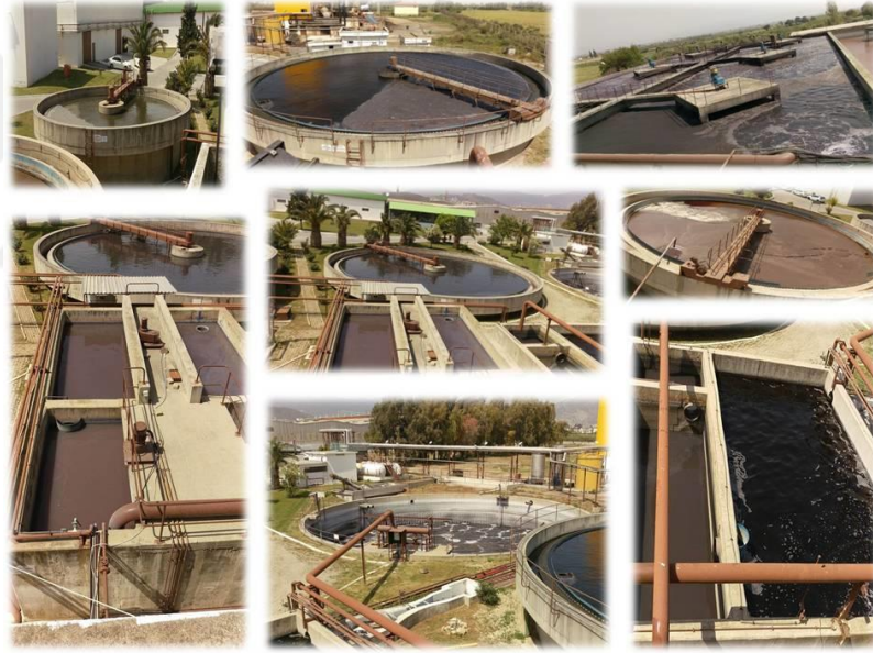
Şekil.5. Tekstil atıksu arıtım tesisine ait görseller (2018).
