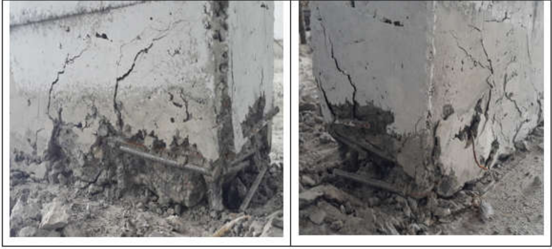
Şekil 3.50. 3.Deneyde güçlendirme için kullanılan 2 nolu dış perde tabanından dökülen kabuk betonu.
