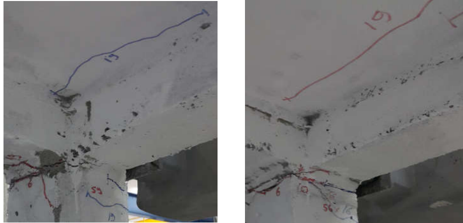
Şekil 3.34. 1.Deney 19.döngüde döşemelerde çatlak oluşumu.
