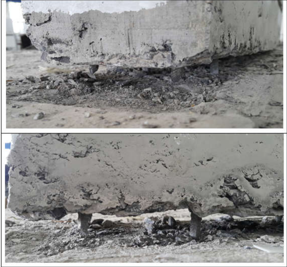
Şekil 3.49. 3.Deneyde güçlendirme için kullanılan 2 nolu dış perde tabanından kopan boyuna donatılar.
