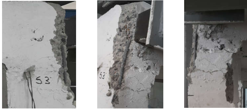
Şekil 3.40. 2.Deney sonunda S3 kolonu ve bu kolonun birleştiği kirişlerin durumu.
