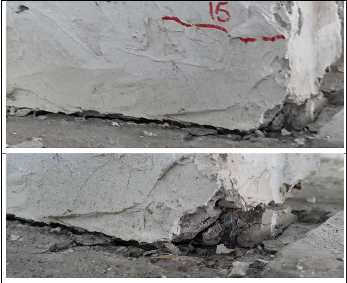
Şekil 3.61. P1 perdesinin tabanı-temel birleşim bölgesindeki ayrılma.
