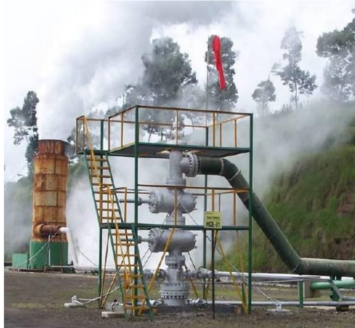
Şekil 3.23 : Endonezya'da bulunan bir jeotermal tesisteki valf ve boruları içeren kuyu başı [45].
