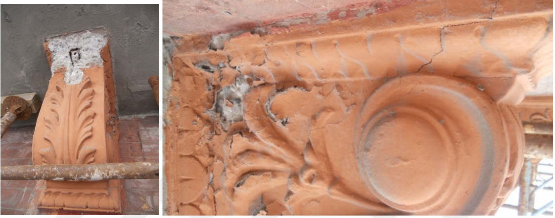
Şekil 3.48 Spada Sarayına ait hasarlı eli böğründeleri [113][114]
