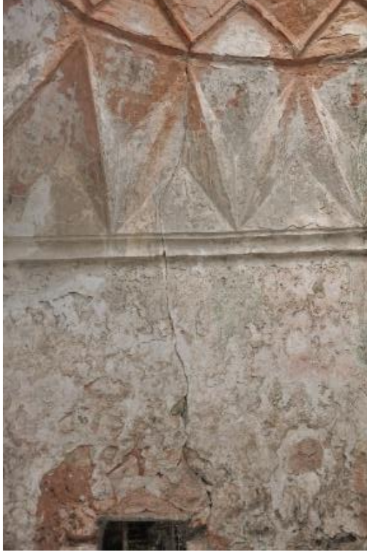
Resim 2.11. Edirne Mihâl Bey Hamamı halvet duvarı çatlağı (2016)
