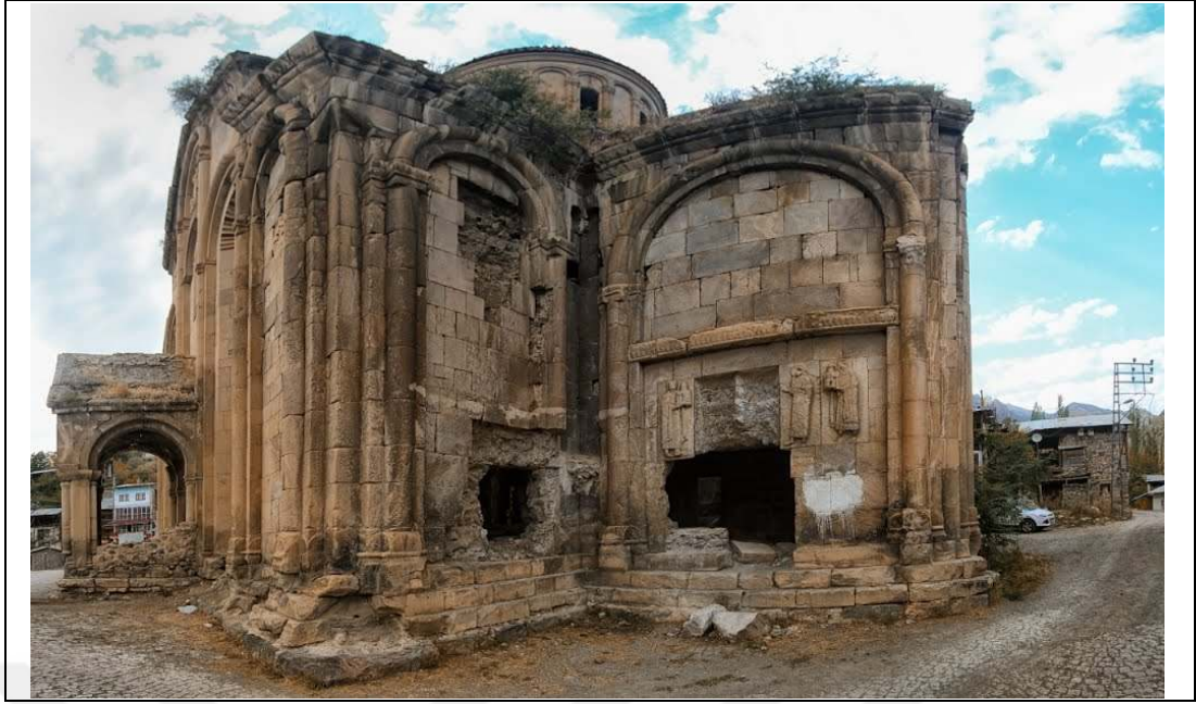
Şekil 5.10: İnsanlar tarafından duvarlarda açılan oyuklar ve delikler.
