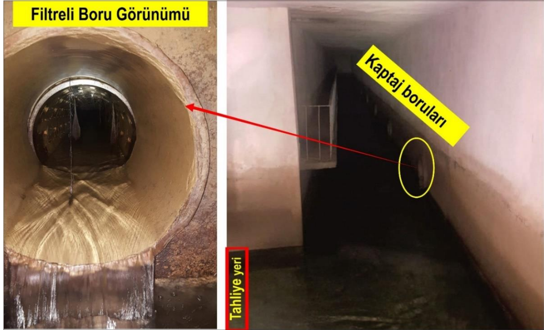
Şekil 5.17.Kaptaj içi ve filtreli boru görünümü
