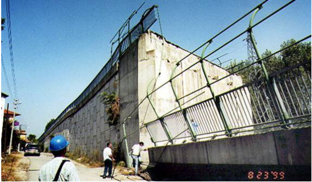
Şekil 2.11 : Kocaeli (İzmit) Depremi, Arifiye Köprüsü toprakarme istinat duvarları. (REAS, 1999)
