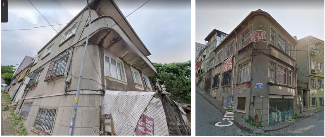
Şekil 3.47 Yapı köşeleri ve balkon parapetlerinde görülen kavisli hareketler (sol) (Aytek, 2022) (sağ) (Google maps sokak görünümü, 2014)
