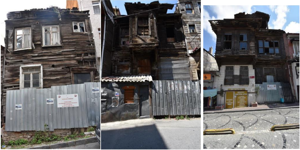
Şekil 3.109 Derin yapısal problem görülen yapılar (Aytek, 2022)
