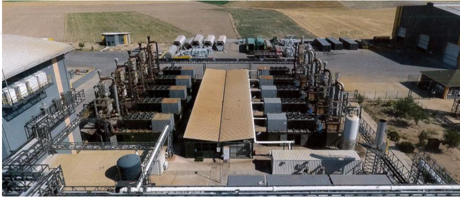
Şekil 4.27. Enerji Üretim Tesisi ve Kumanda Kontrol Binası
