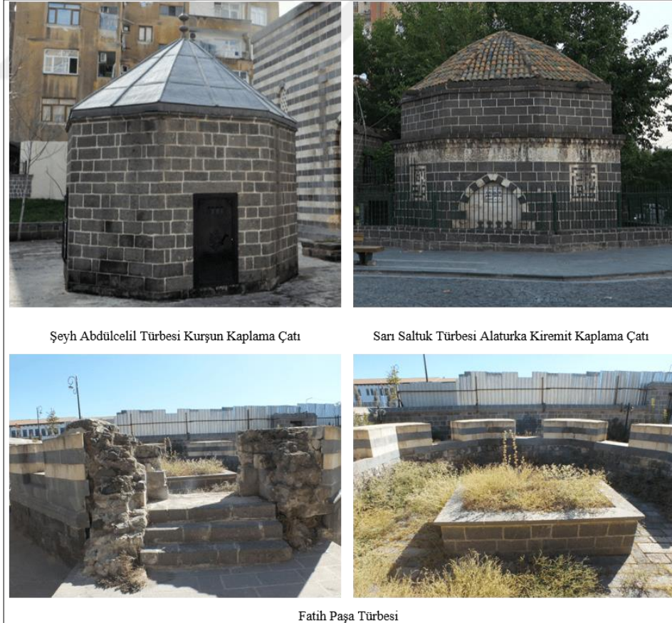
Şekil 6.12 Restorasyon sonrası türbe yapılarında oluşan hasarlar
