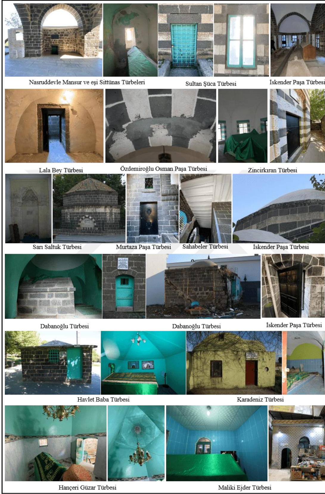
Şekil 6.11 Türbe yapılarında aykırı ek müdahaleleri
