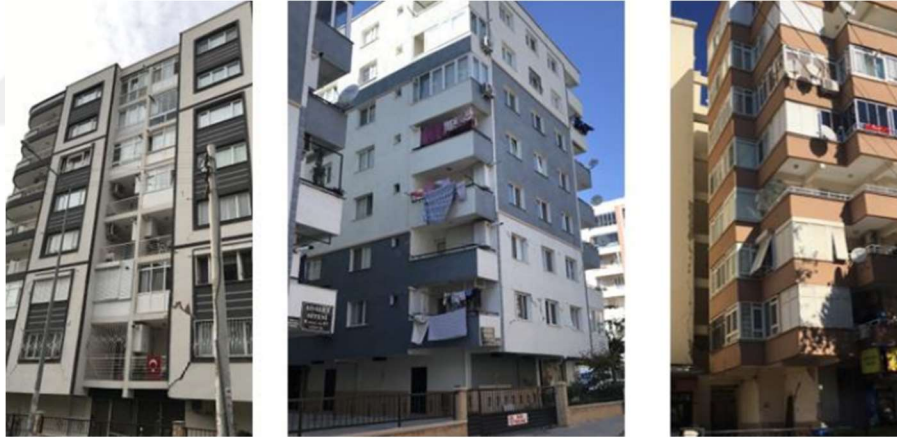
Şekil 1.3. Çıkmalardan Kaynaklı Hasarlar [4]
