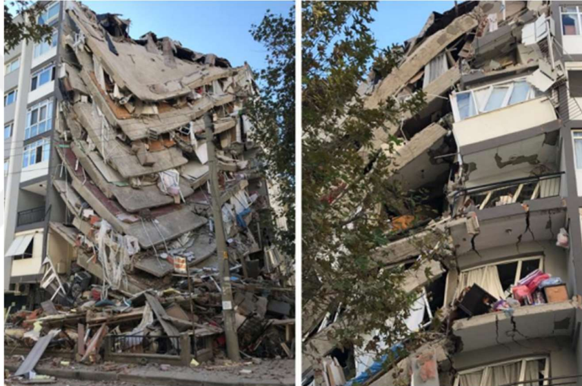
Şekil 1.6. Köşe Kolon Hasarı [3]
