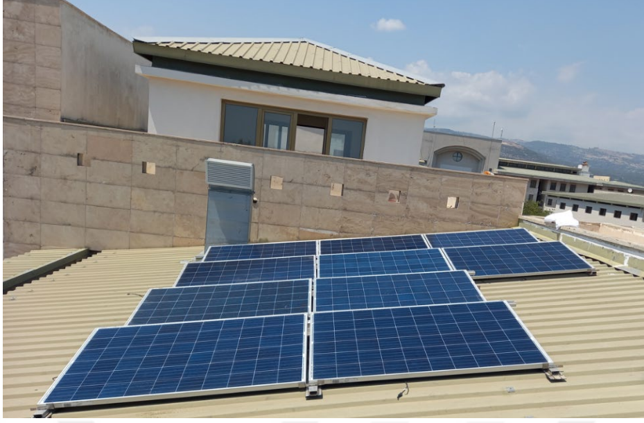
Şekil 3.3. Fotovoltaik güç sistemi.
