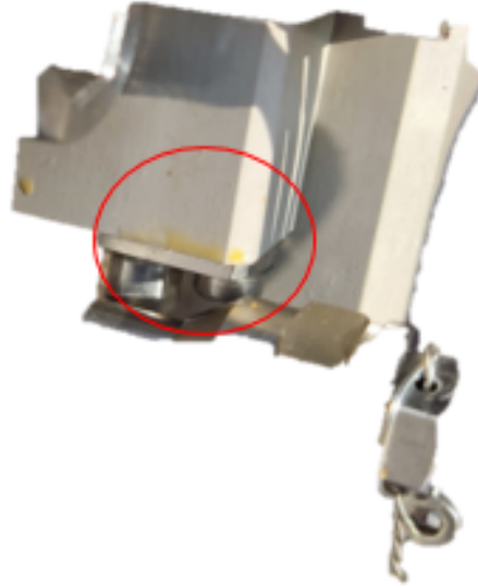
Şekil 4.6: Yağ Ayırıcı Bölgesi Yağ Kaçağı
