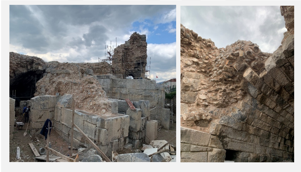
Şekil 4.49 İznik Antik Roma Tiyatrosu; cavea ve galerilerdeki strüktürel bozulmalar (Yavuz, 2023.)
