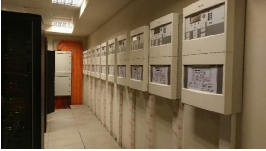
Şekil 4.15 : Bina kontrol odası.
