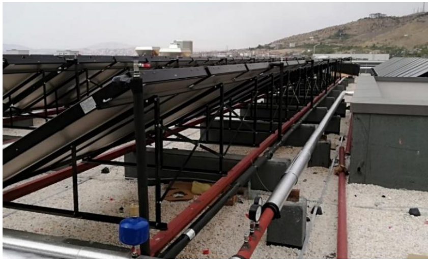
Őekil 4.29 : Güneř paneli kolektörleri.
