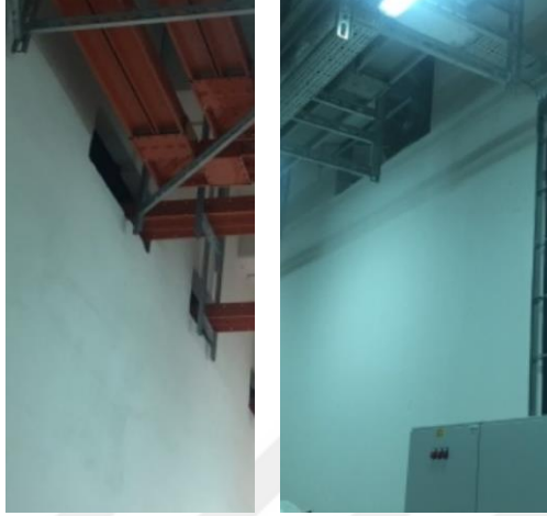
Şekil 4.110 : Duvarda olan kontrolsüz açıklıklar.
