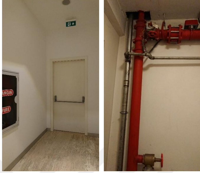
Şekil 4.95 : Yangın kapısı ve merdivende olan itfaiye ağzı.
