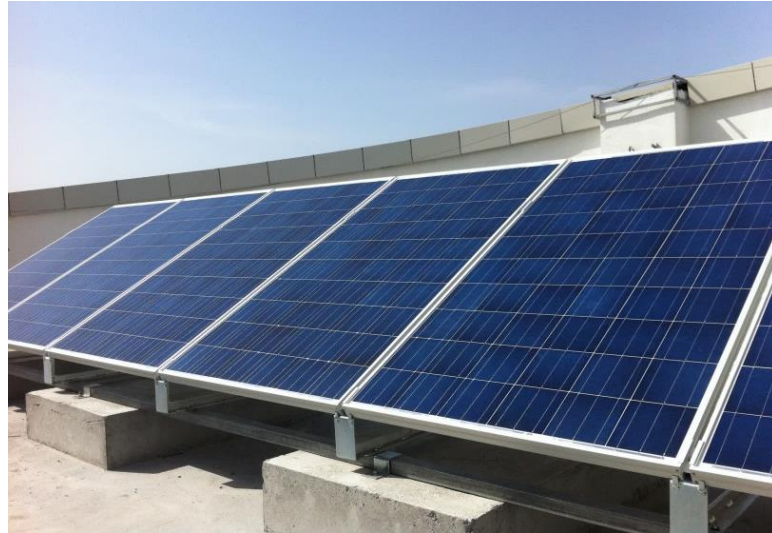
Şekil 4.135 : Güneş paneli (Url-10).
