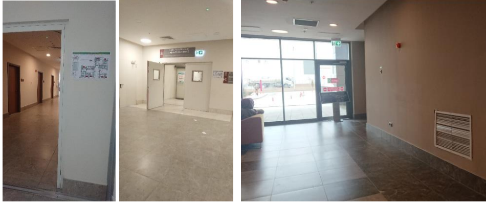
Şekil 4.20 : Fethi Sekin Şehir Hastanesi yangın kapıları.
