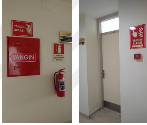
Şekil 4.36 : Yangın dolabı ve alarm butonu.
