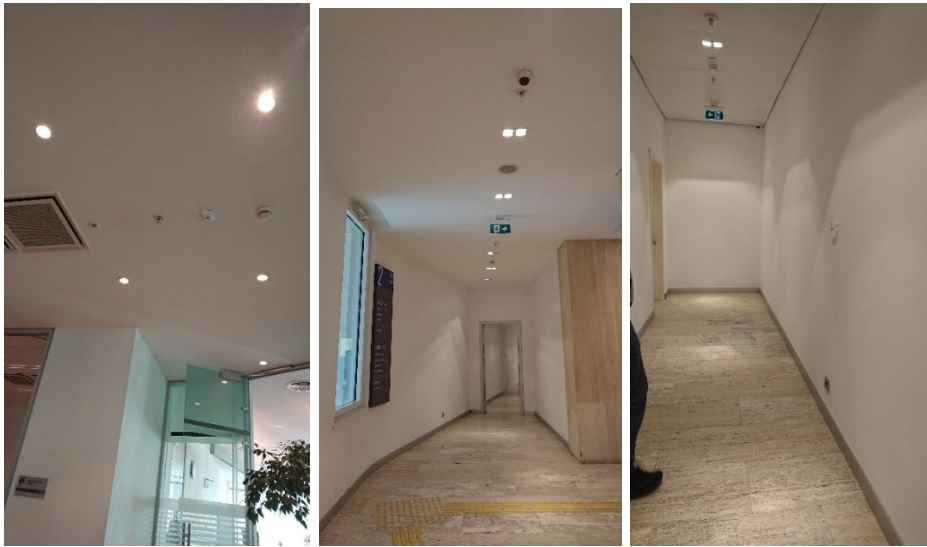
Şekil 4.94 : Binada yer alan yağmurlama sistemi ve acil durum yönlendirme üniteleri.
