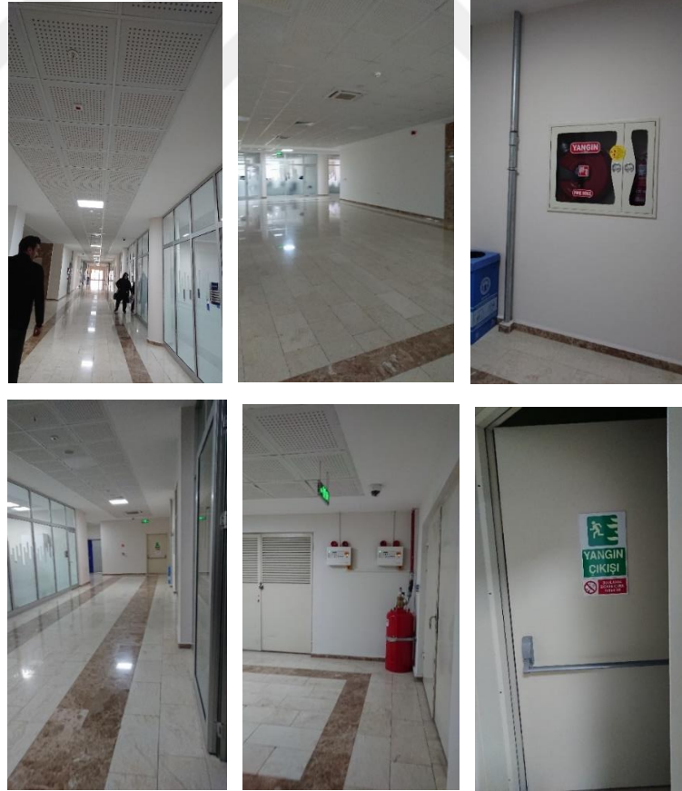
Şekil 4.139 : Acil durum yönlendimeleri üniteleri, yangın algılama söndürme sistemleri ve yangın kapıları.
