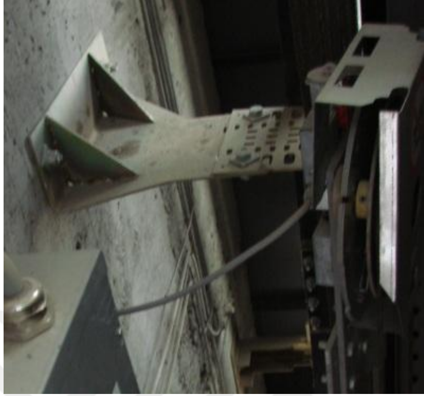
Şekil 3.18 : Konsol eğilmesi, hasara uğraması [21]
