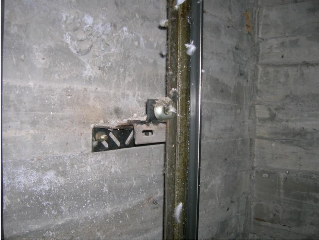
Şekil 3.17 : Konsol eğilmesi, hasara uğraması [21]
