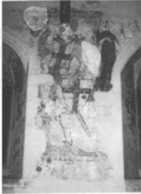
Şekil 5.28 Taş duvarlarda meydana gelen bozulmalar (Elborombaly, 2016)
