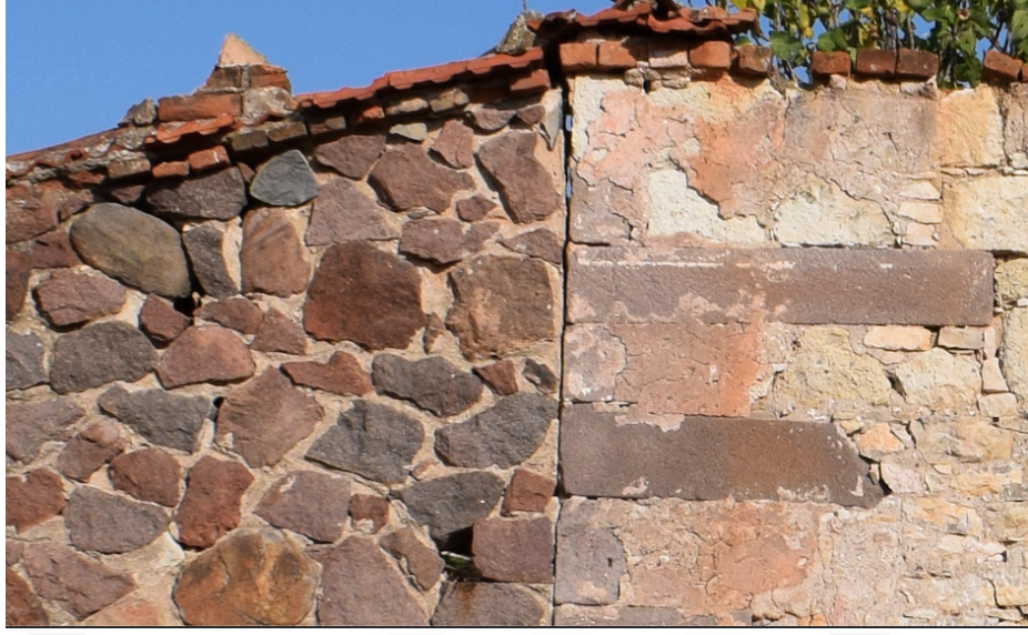
Şekil 6.72 Taş duvarda meydana gelen ayrılma (Kişisel arşiv, 2019)
