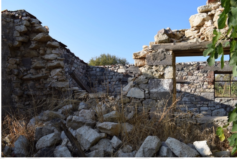
Şekil 6.71 İç duvarların yıkılan kısımları (Kişisel arşiv, 2019)
