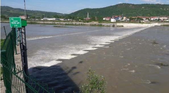
e) Çaycuma köprüsü mansabında düşülü brit yapısına ait görüntü.
