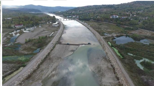
f) Uygun hidrolik akışı sağlamak üzere yatak tanzim çalışması yapılmış memba görüntüsü.
