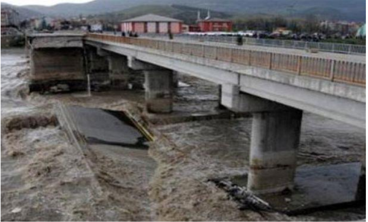
Şekil 2.4 Çaycuma köprüsünde aşağıya düşen tabliye.
