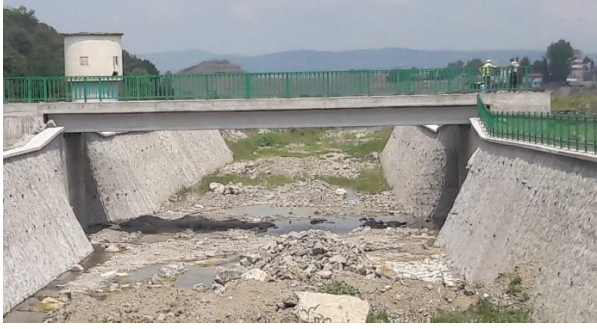
a) Tek açıklıklı öngerme kirişli köprü kenar ayakları kagir duvarla emniyet altına alınmıştır.
