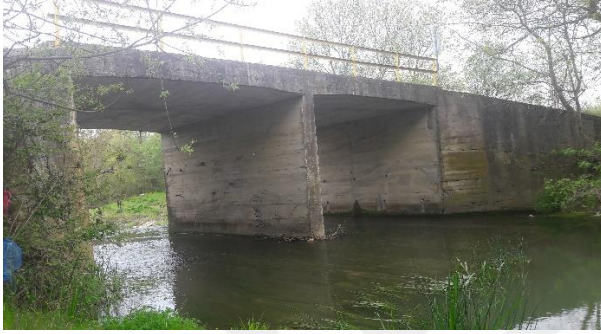
c) Köprü orta ayakları tıkanmalara karşı risk teşkil etmektedir.
