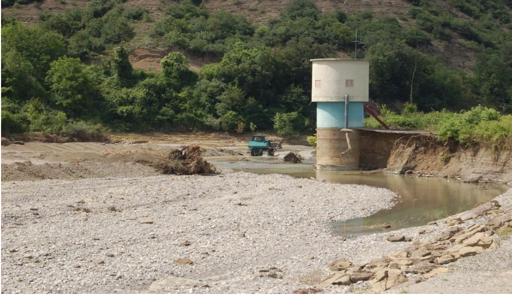
Şekil 2.3 İçme suyu keson kuyusu etrafında oluşan oyulmalar.
