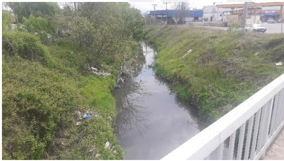
e) Köprü memba yönünde dere üzerinde herhangi bir koruma yapısı yoktur.
