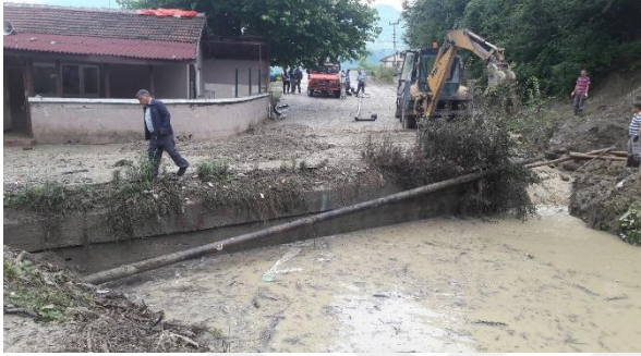
c) Taşkın anında su yüküne yukarı havzadan gelen rusubat ilavesi ile tıkanan kemer köprü.
