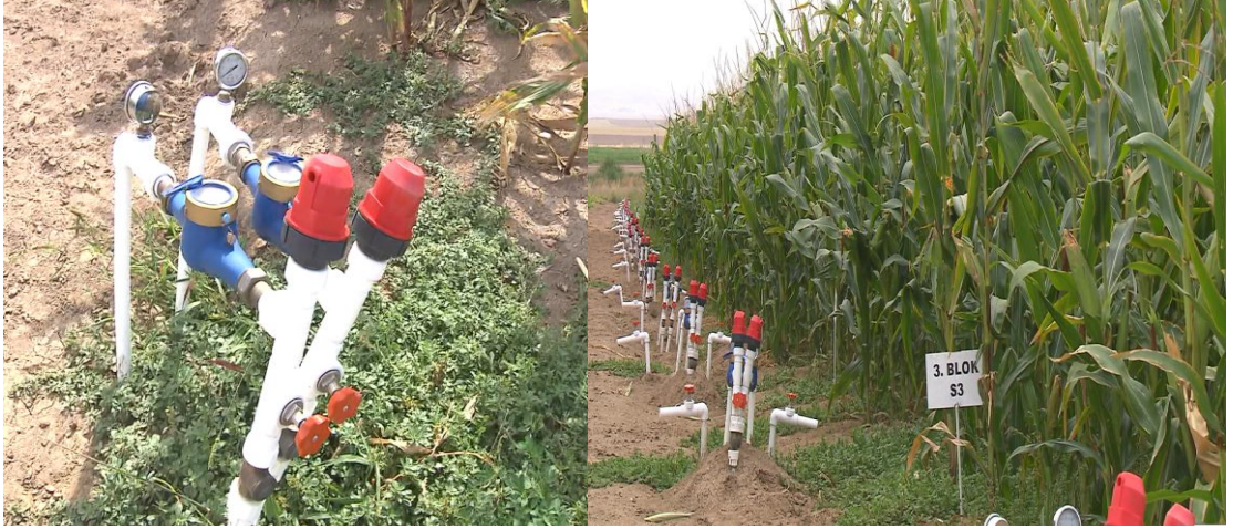
Şekil 3.9 Manifold giriş hattı vana, vantuz, sayaç ve manometre
