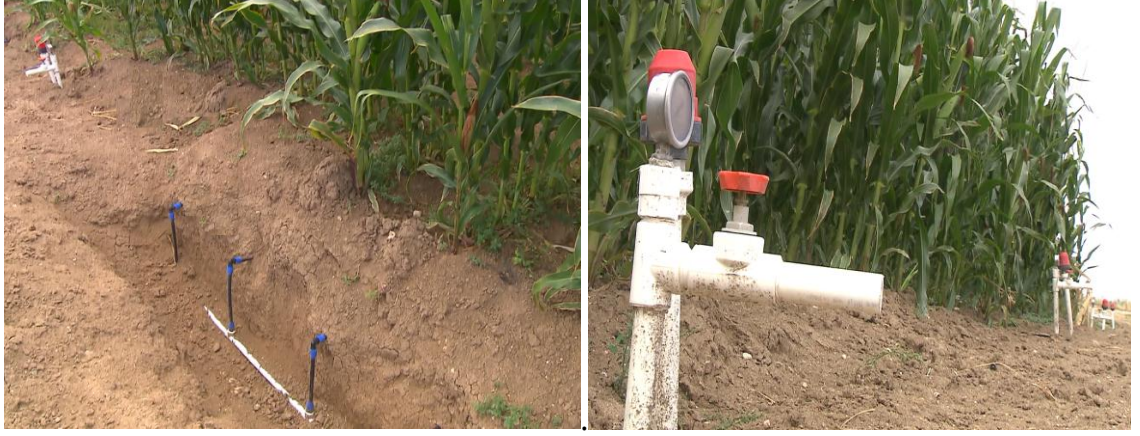
Şekil 3.10 Tahliye manifold hattı ve bağlantı elemanları
