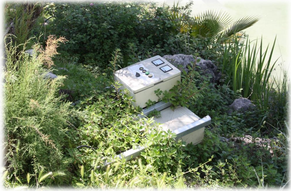
Şekil 5.4. Motopomp ve dalgıç pompa kontrol rölesi
