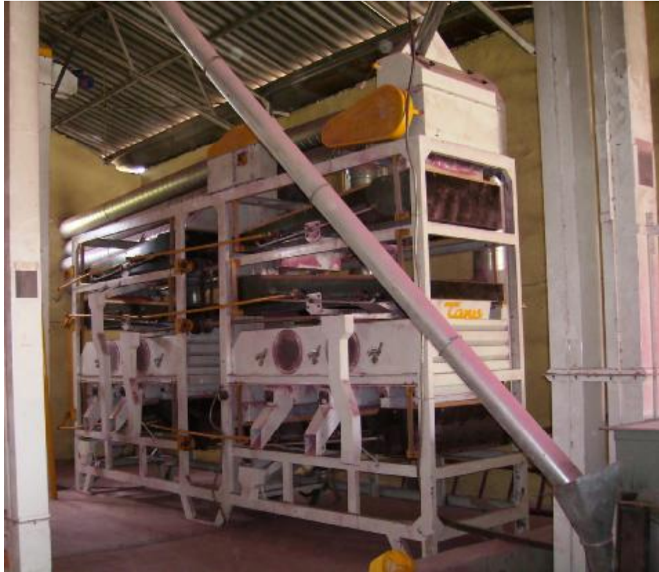
Şekil 3.17. Kılçık kırma ve ön eleme ünitesi
