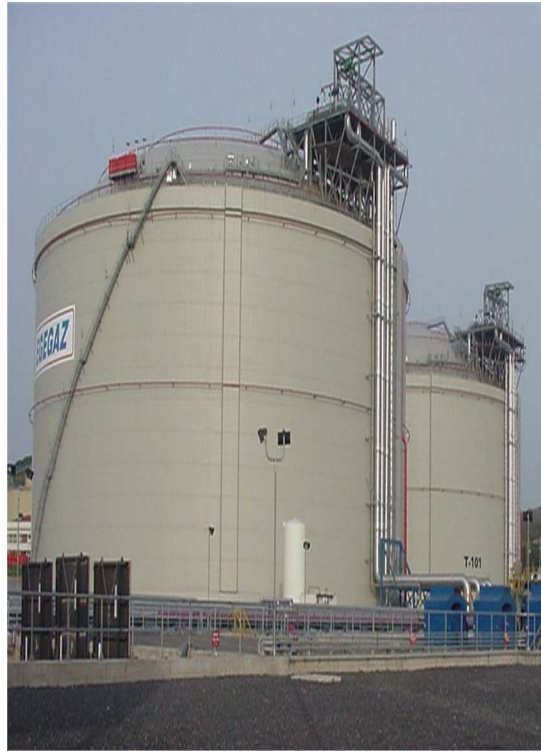
Figure 6.10. Egegaz LNG storage tanks
