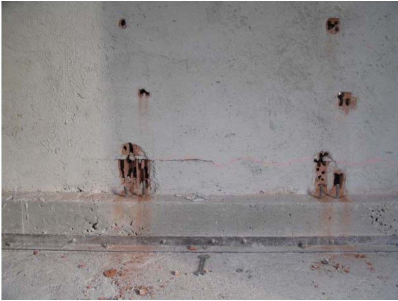
Resim 3.37. Deney Yapısı-5 batı cephe iç duvarının 20. yükleme sonunda görünüşü
