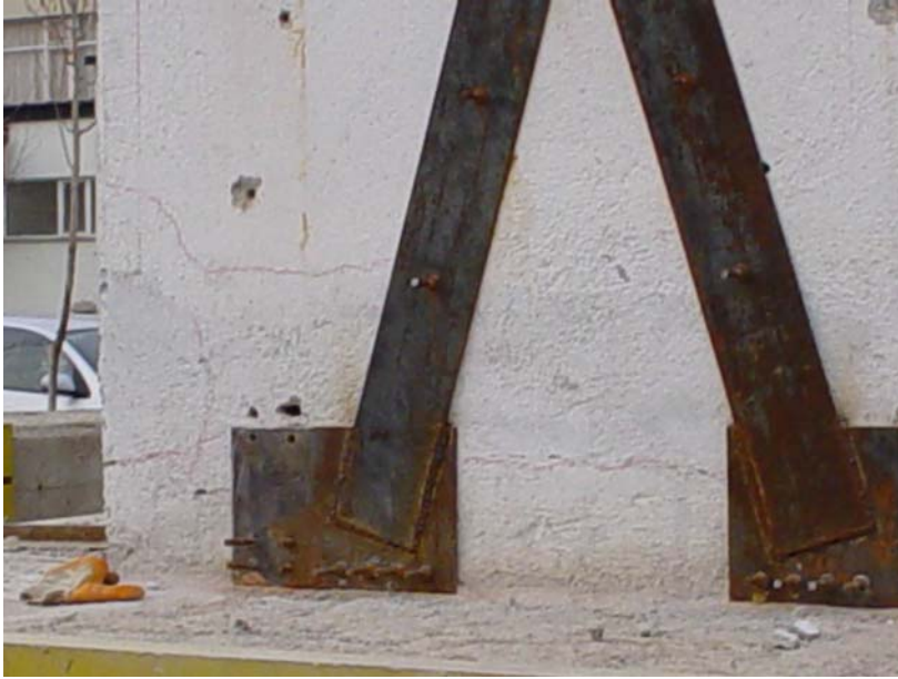
Resim 3.35. Deney Yapısı-5 güney cephe A1 duvarının 20. yükleme sonunda görünüşü
