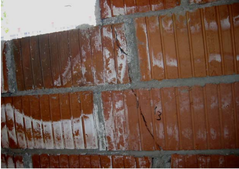
Resim 3.12. Deney Yapısı-1 kuzey cephe iç duvarın 13. yükleme sonunda görünüşü
