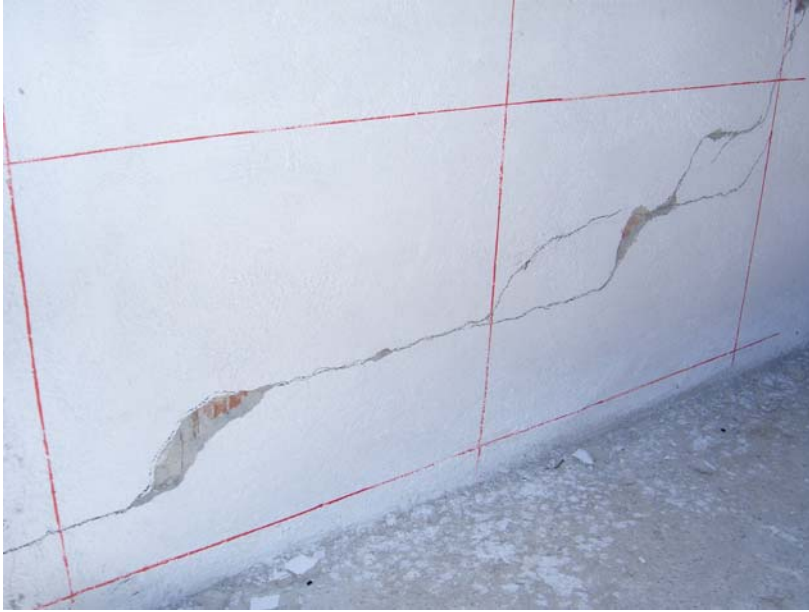
Resim 3.7. Deney Yapısı-1 kuzey cephenin 12. yükleme sonunda görünüşü
