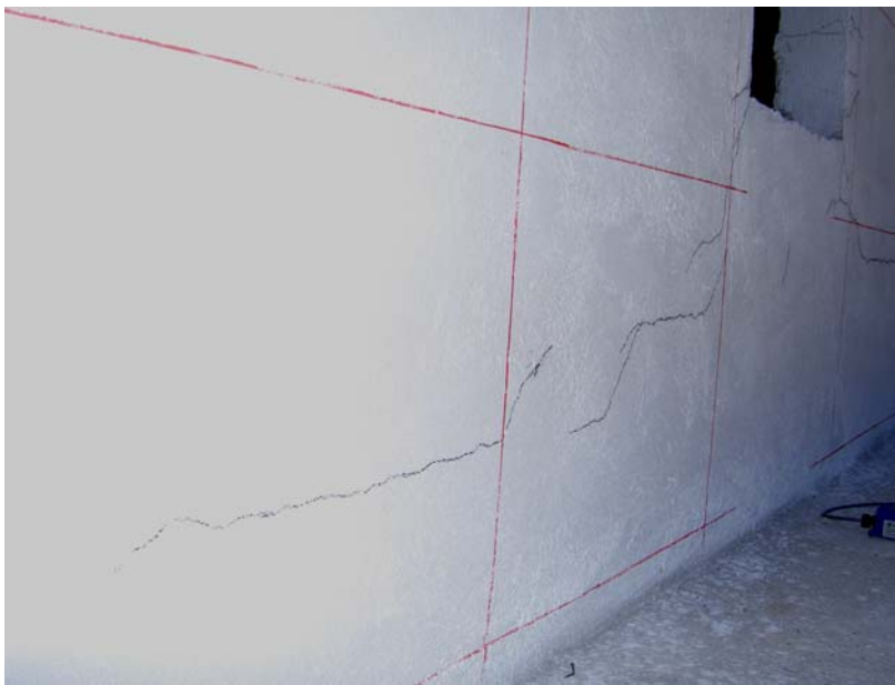
Resim 3.4. Deney Yapısı-1 kuzey cephenin 11. yükleme sonunda görünüşü
