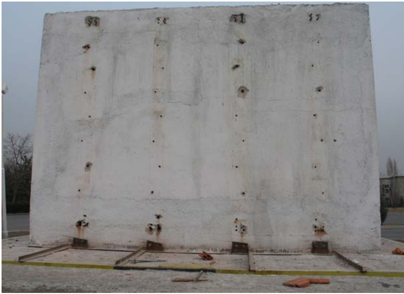
Resim 3.41. Deney Yapısı-5 batı cephenin 20. yükleme sonunda görünüşü
