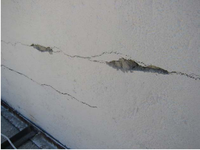
Resim 3.11. Deney Yapısı-1 batı cephenin 13. yükleme sonunda görünüşü
