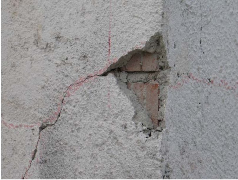
Resim 3.39. Deney Yapısı-5 güney cephe A2 duvar köşesinin 20. yükleme sonunda görünüşü
