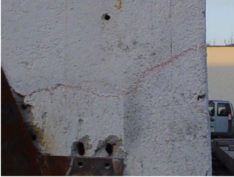
Resim 3.32. Deney Yapısı-4 güney cephe A2 duvarının 20. yükleme sonunda görünüşü
