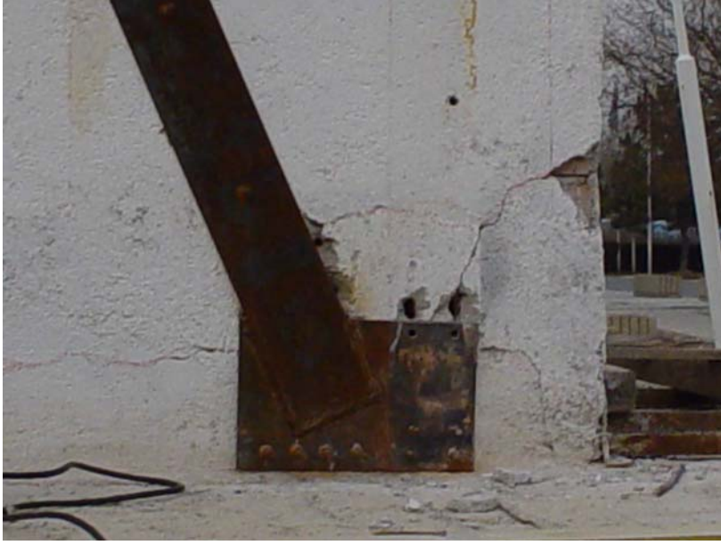
Resim 3.36. Deney Yapısı-5 kuzey cephe B1 duvarının 20. yükleme sonunda görünüşü
