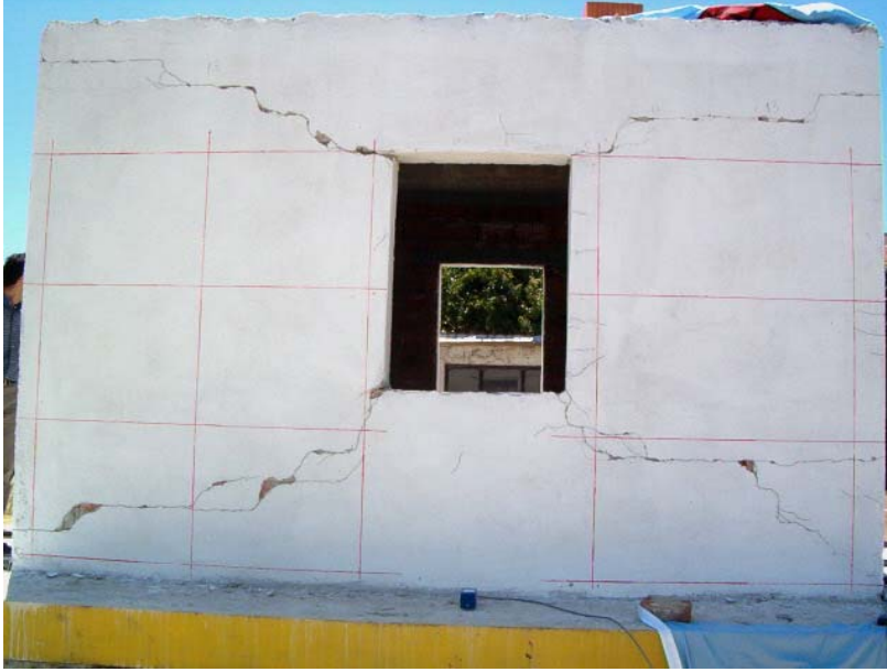
Resim 3.13. Deney Yapısı-1 kuzey cephenin 14. yükleme sonunda görünüşü
