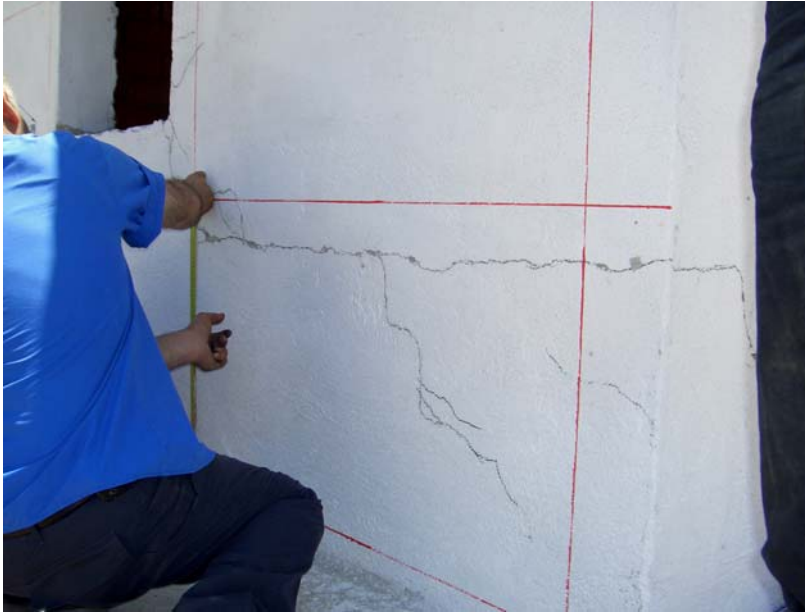
Resim 3.8. Deney Yapısı-1 kuzey cephenin 12. yükleme sonunda görünüşü
