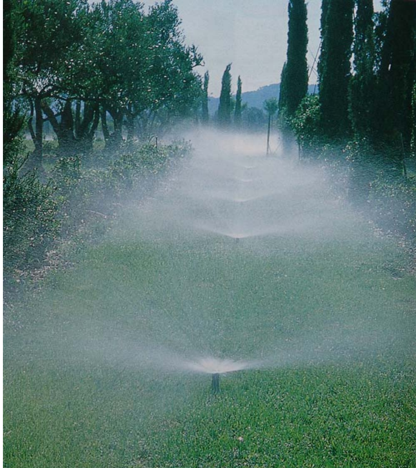
Resim 8.3: Sprinkler bahçe sulama sistemi.
