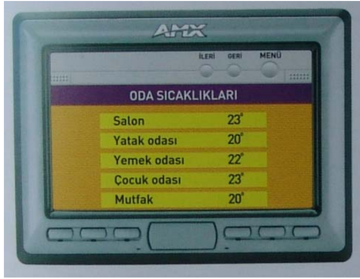
Resim 3.16: Oda sıcaklıklarının touch panelden izlenmesi.
