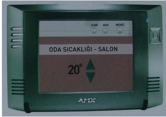
Resim 3.18: Oda sıcaklık derecesi seçilmiş touch panel.
