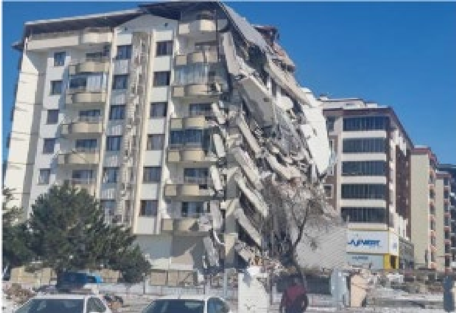
2.12. Kahramanmaraş Depremi, Malatya 2023
