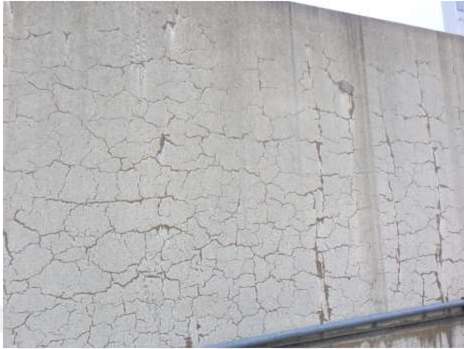
Şekil 4. ASR kaynaklı tipik harita çatlağı
