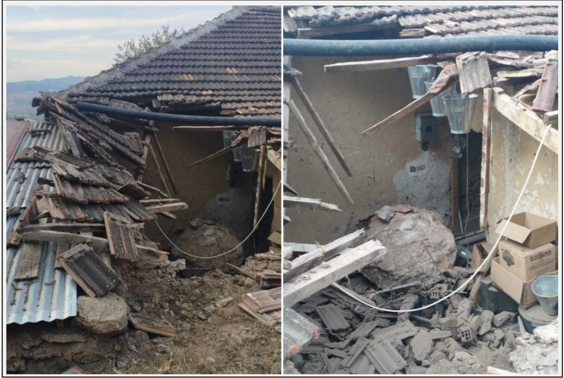
Şekil 71. Aşağıdahdere'de taş ocaklarından yuvarlanarak gelen kaya bloklarının zarar verdiği bir ev (Url 12)
