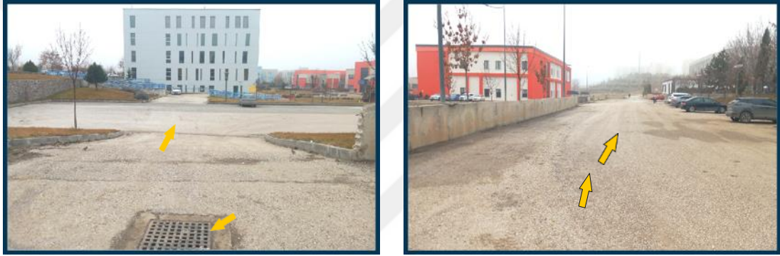
Görsel 5. 17. Düzensiz Zemin Yapısı ve Yetersiz Yüzey Uyarıları (Yazarın kişisel arşivinden, 2025).
