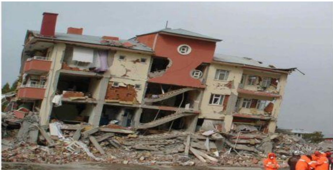
Bild 1.1: Ein Gebäude in Gölcük nach dem Erdbeben(17.08.1999) der Magnitude 7,4 auf der Richterskala (kocaelioncu.com)
