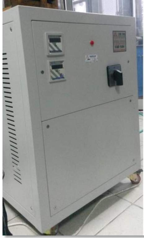
Şekil 3.21: 350V- 90A varyak transformatör.
