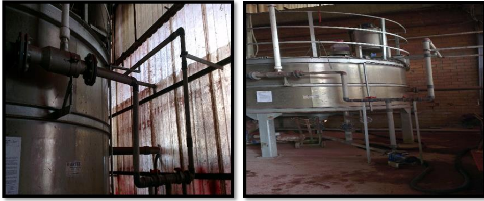
Resim 4.12. Sirkülasyon pompası ve tesisatı
