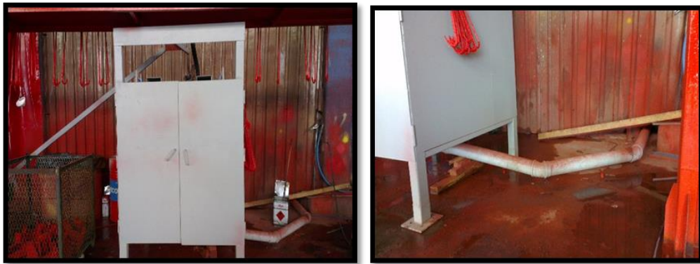
Resim 4.13. Çamur alma yapısı ve atıksu iletim tesisatı
