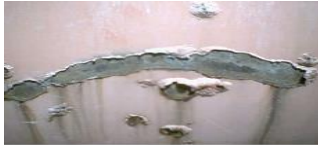
Şekil 7. Boya altından yürüyen filiform korozyonunun görünümü.
