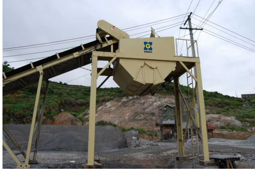
Şekil 2.9. Dış karıştırma ünitesi stabilize zemin haznesi
