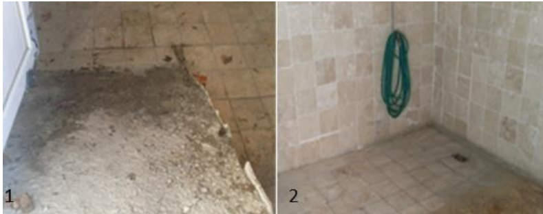
Şekil 11: Serinhisar İlçe Hastanesi tıbbi atık geçici atık deposunun iç bölümü
