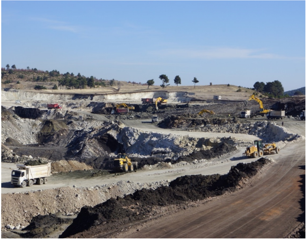
Şekil 6.7 Ayvalı-2 panosundaki çalışmadan görünüm
