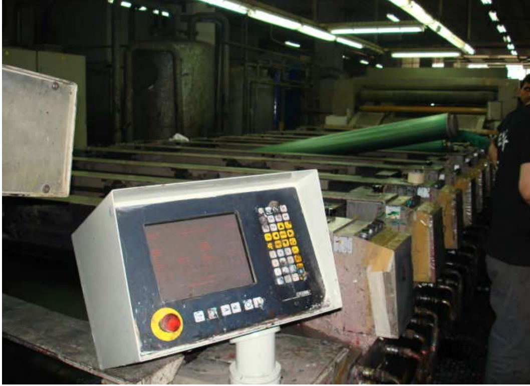
Şekil 10.8. Kontrol Paneli (Programatör)
