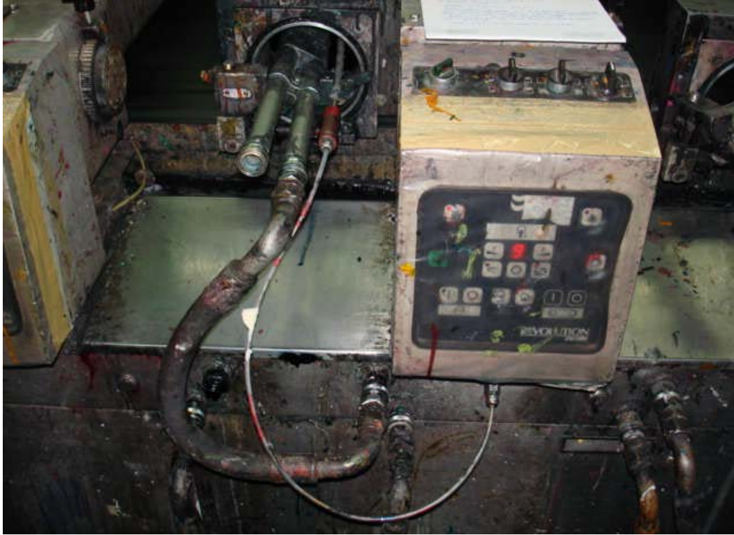
Şekil 10.9. PAM Kontrol Paneli
