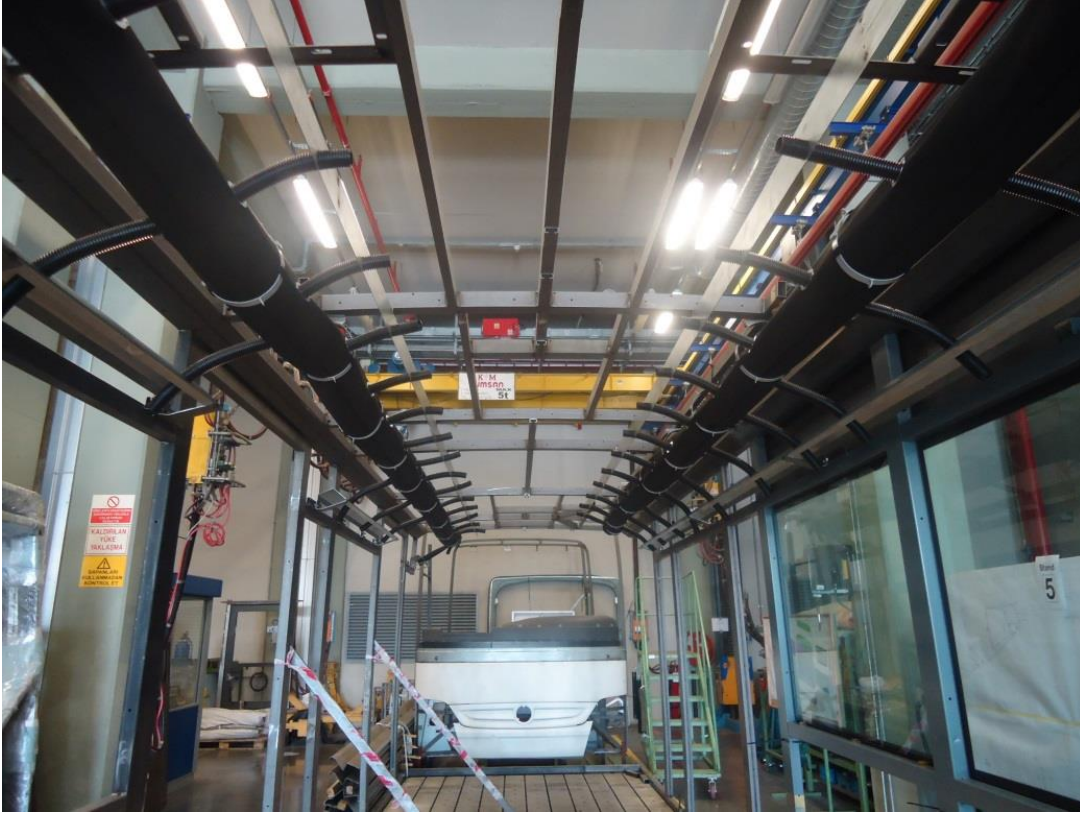
Şekil 6.4 : Tekstil hava kanalı genel görünüş.
