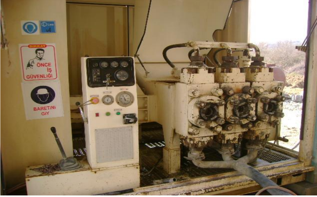
Şekil 3.11. Pompa ünitesinden görünüm.
