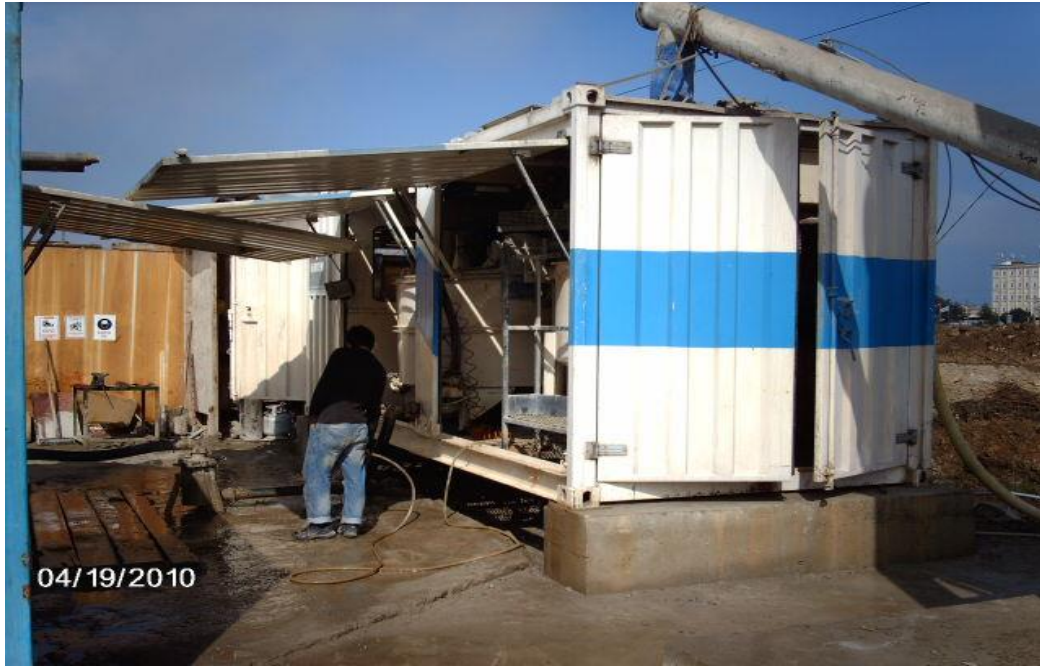
Şekil 3.8. Santral ünitesinden görünüm.
