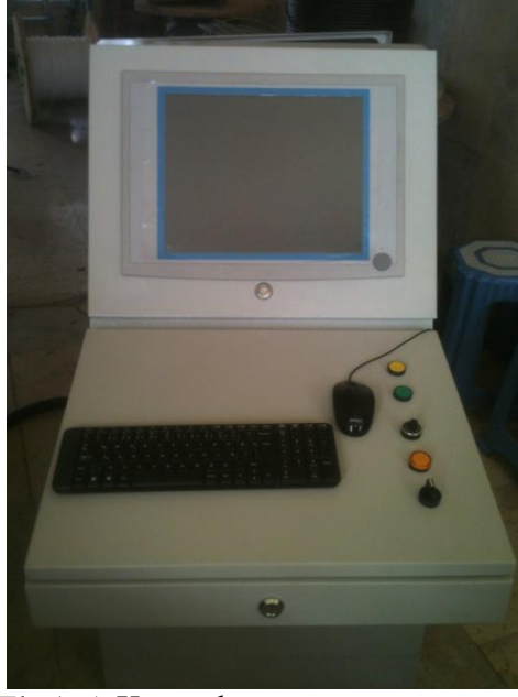
Ek-A.5. Kontrol panosu ön görünümü
