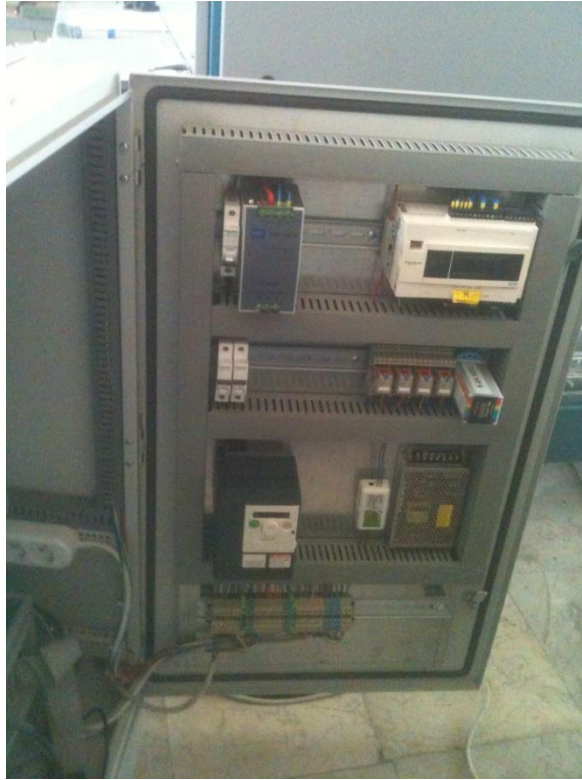
Ek-A.6. Kontrol panosun arka görünümü
