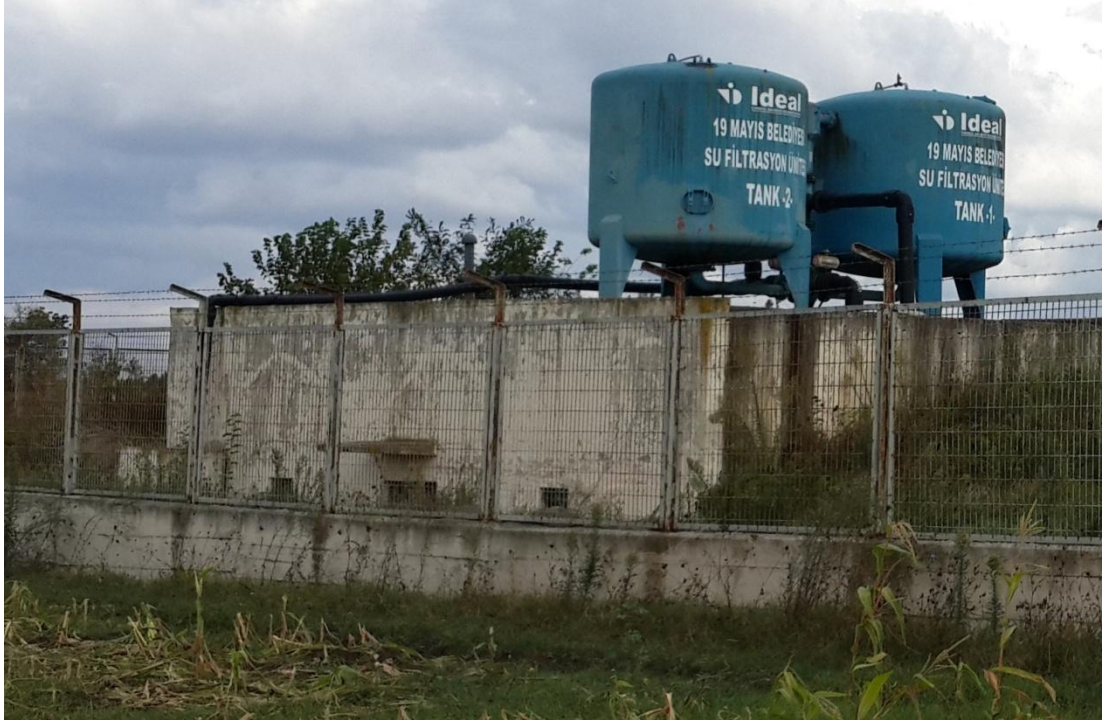
Şekil 3.3 19 Mayıs ilçesi ana depo ve filtrasyon üniteleri
