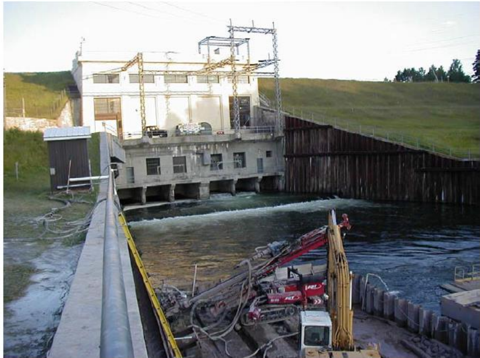
Şekil 5.11 : Hodenpyl Barajı-Mansap Bölgesi İstinat Duvarı;yüksek plastisiteli killerde P_{kilit}=1360 kN ard enjeksiyonlu SBMA ankrağı (Bruce ve diğerleri, 2004)
