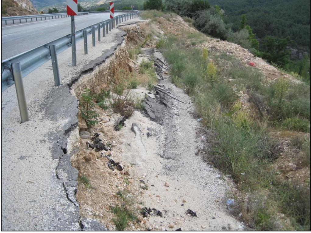
Şekil 5.14. Heyelanlı kesimin görünümü ve heyelan sonucu oluşan deformasyonlar
