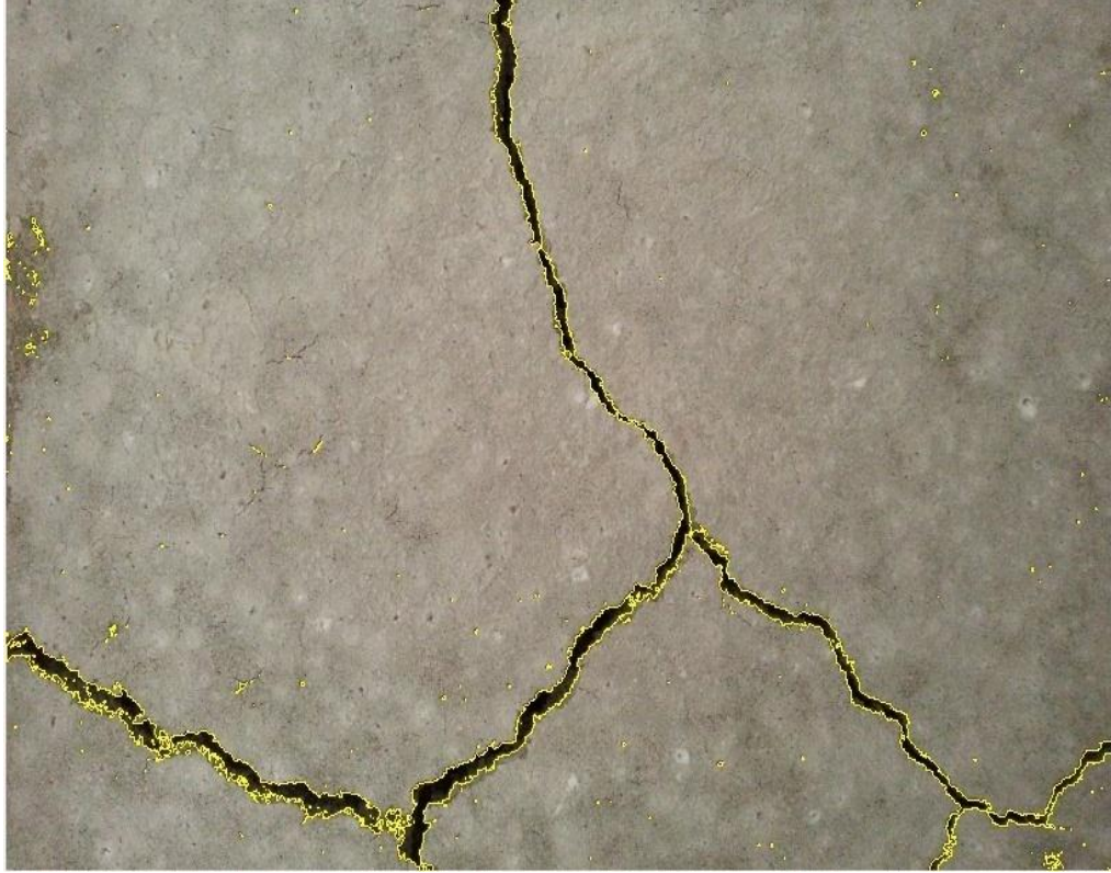
Şekil 6.60: İşaretlenen çatlak bölgenin sınırlandırılması (kireç %3, 7.gün).
