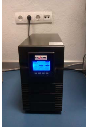
Resim 5: Kesintisiz güç kaynağı.
