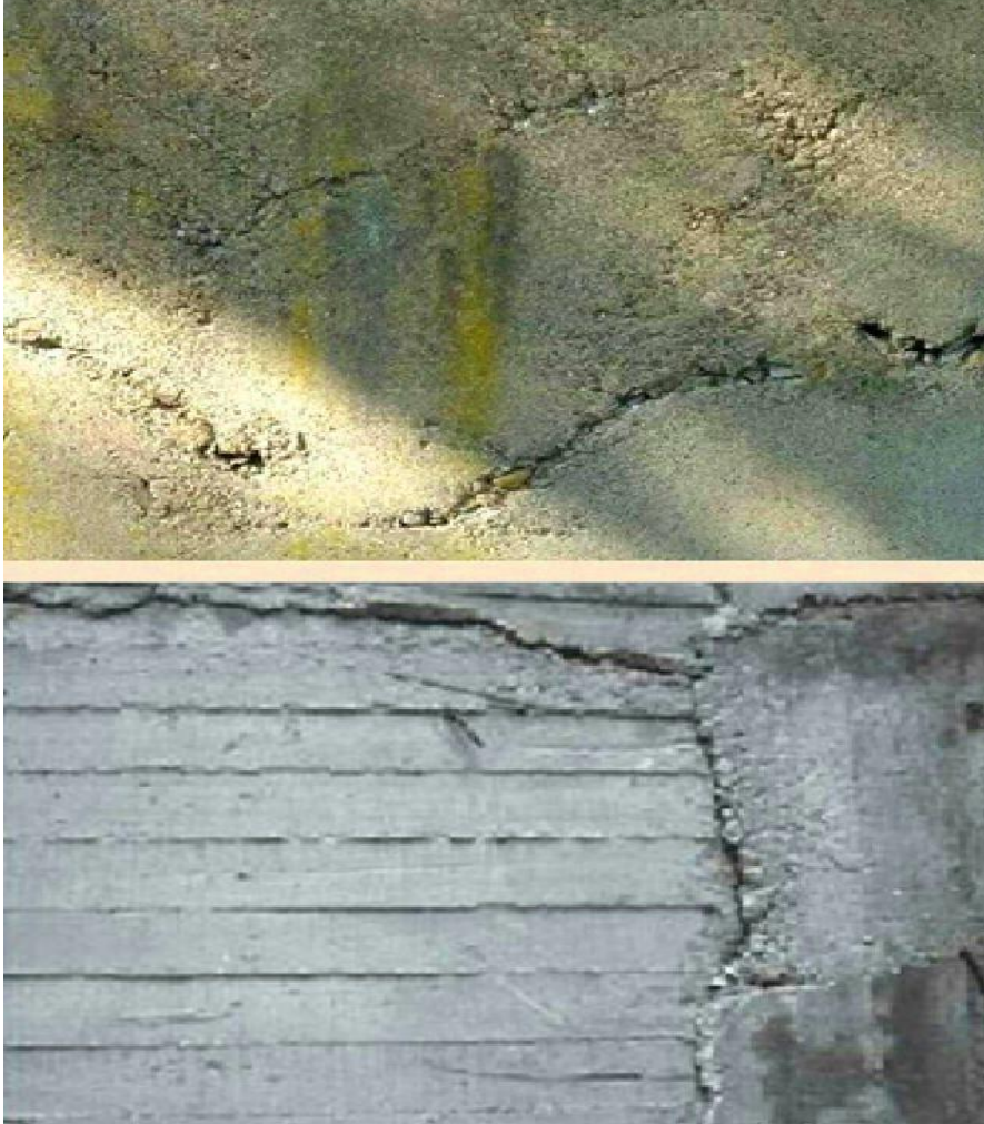
Şekil 2.2. Farklı zamanlarda dökülerek ek yerleri oluşturulan betonarme istinad duvarında oluşan soğuk derz betonların örnekleri
