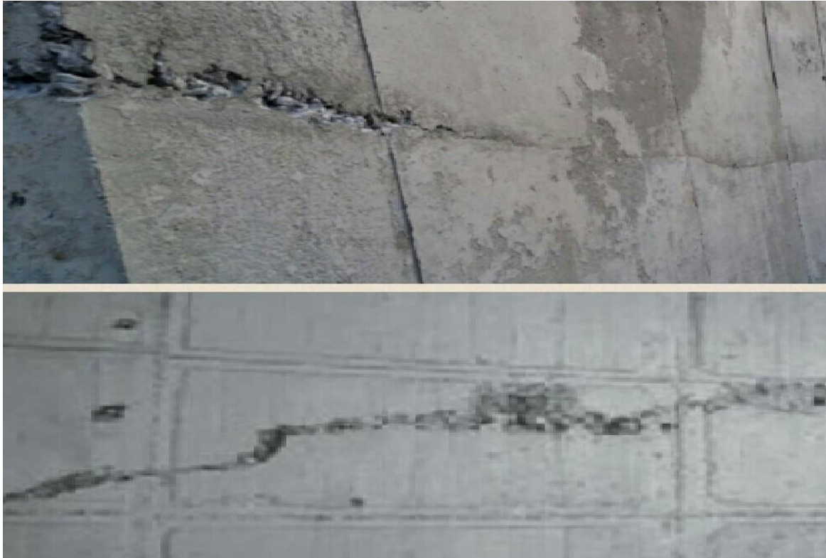
Şekil 2.1. Bodrum kat çevre perdelerinin beton dökümü sırasında, uygulamadaki gecikme sebebiyle ilk tabakalar arasında meydana gelen soğuk derz oluşan beton örnekleri
