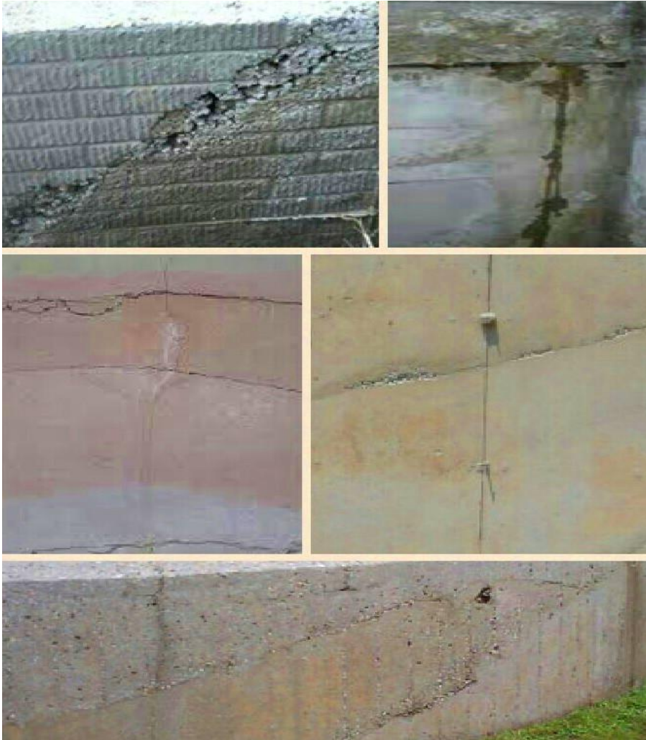
Şekil 2.4. Soğuk derz oluşan betonların farklı örnekleri
