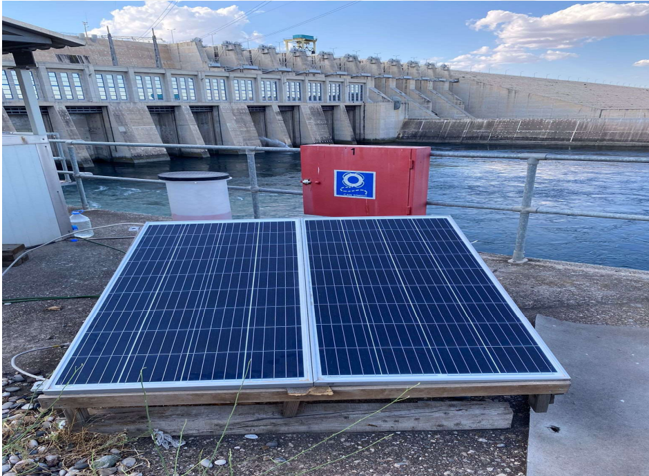
Şekil 5.11 Kurulumu Yapılan Panellerin Önden Görünümü
