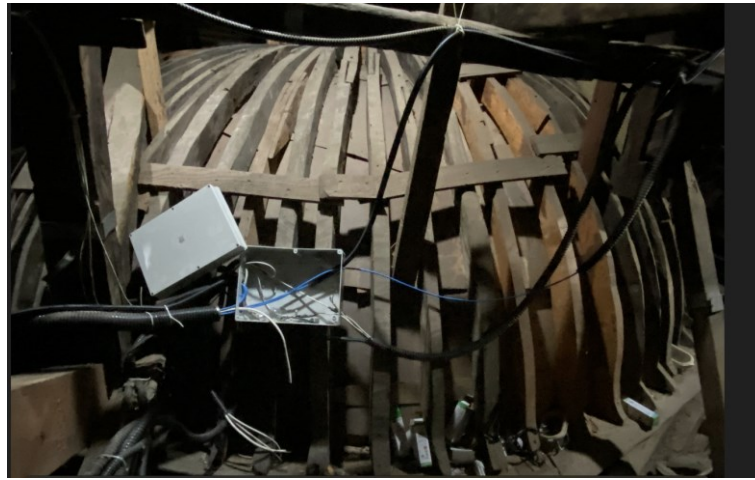
Şekil 2.135 Ahşap kubbenin kaburgaları üzerinden geçen elektrik kabloları, 2022 (Kasaboğlu, E.)
