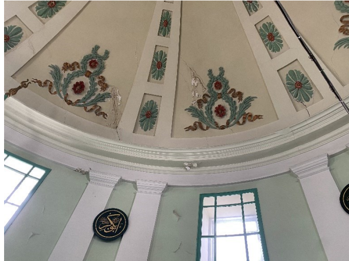
Şekil 4.17 Asariye Camisi'nin ahşap kubbesinin alt yüzeyinde görülen yağmur suyu kaynaklı sıva, bezeme bozulmaları, 2021 (Kasaboğlu, E.)
