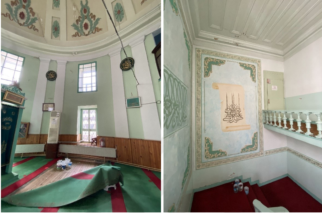
Şekil 4.16 Asariye Camisi'nin ahşap kubbesinin ve diğer düz ahşap tavan bölümlerinin çatıdan yağmur suyu alması, 2021 (Kasaboğlu, E.)
