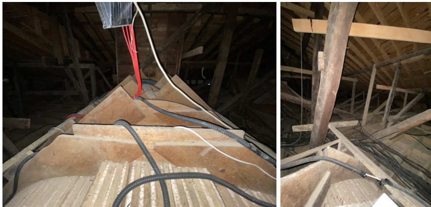
Şekil 2.63 Yahya Efendi Camisi'nin çatı arasında yer alan projektör ve elektrik kabloları, 2021 (Kasaboğlu, E.)
