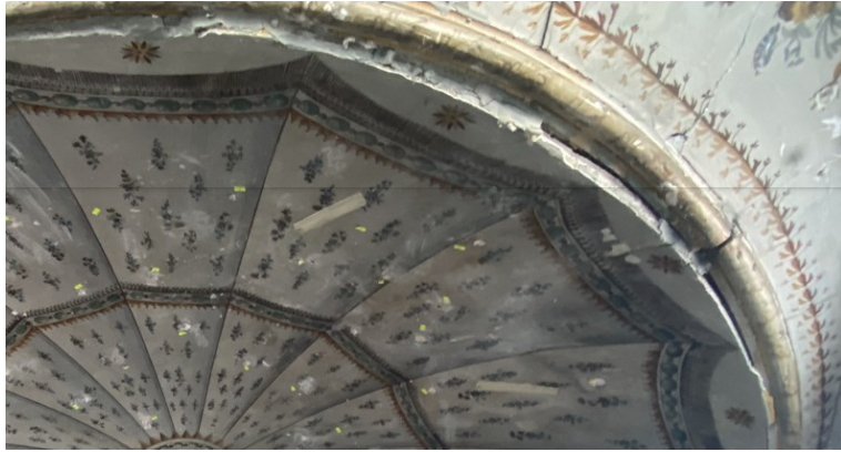
Şekil 2.184 III. Ahmed Köşkü'nün ahşap kubbesinin yüzeyindeki bozulmalar ve sıva tabakasının kalkması, 2021 (Kasaboğlu, E.)
