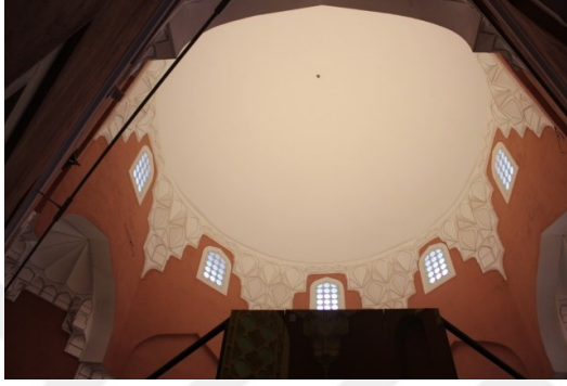
Şekil 2.46 Kubbelerin iç mekâna bakan yüzeyinde görülen stalaktitler (Ayverdi, 1953), onarım sonrası görünüşü 2023 (Kasaboğlu, E.)
