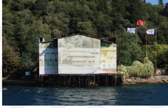
Şekil 2.153 Amcazade Köprülü Hüseyin Paşa Yalısı'nın divanhanesinin bakımsızlıktan dolayı yıkılan meşrutası (Atatürk Kitaplığı Arşivi) ve divanhanenin günümüzdeki durumu, 2020 ( https://kulturenvanteri.com/tr , 2023)
