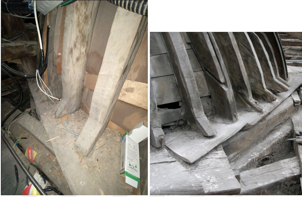
Şekil 4.11 Yeni Cami Hünkâr Kasrı'nın kubbesinin ahşap kaburga- taban çivili birleşimlerindeki yarıma, 2021 (Kasaboğlu, E.) ve (VGM I. Bölge Arşivi)
