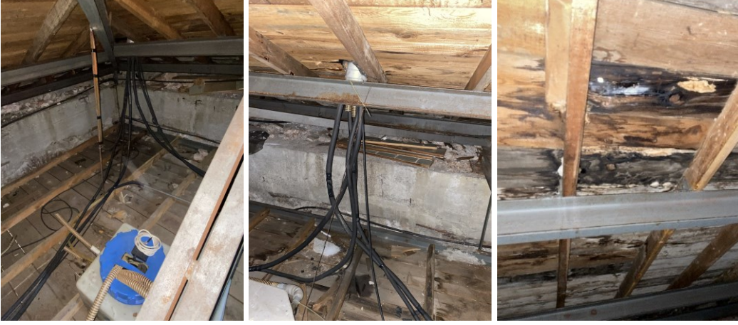
Şekil 2.18 Ahrida Sinagogu’nun çatı arasında gözlemlenen ahşap bozulmaları ve tesisat, 2021 (Kasaboğlu, E.)
