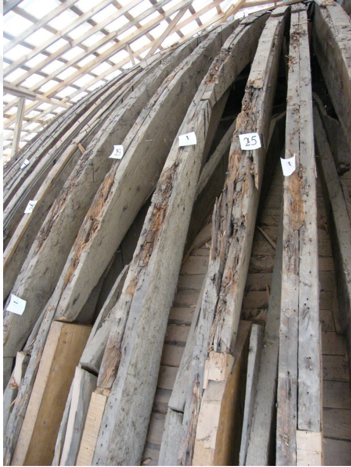
Şekil 4.3 Sadabat Camisi'nin ahşap kubbesinde meydana gelen bozulmalar (VGM 1. Bölge Arşivi)
