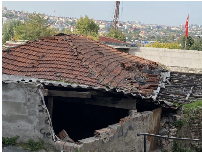
Şekil 4.42 Mayor Sinagogu'nun çökmek üzere olan çatısı, 2021 (Kasaboğlu, E.)
