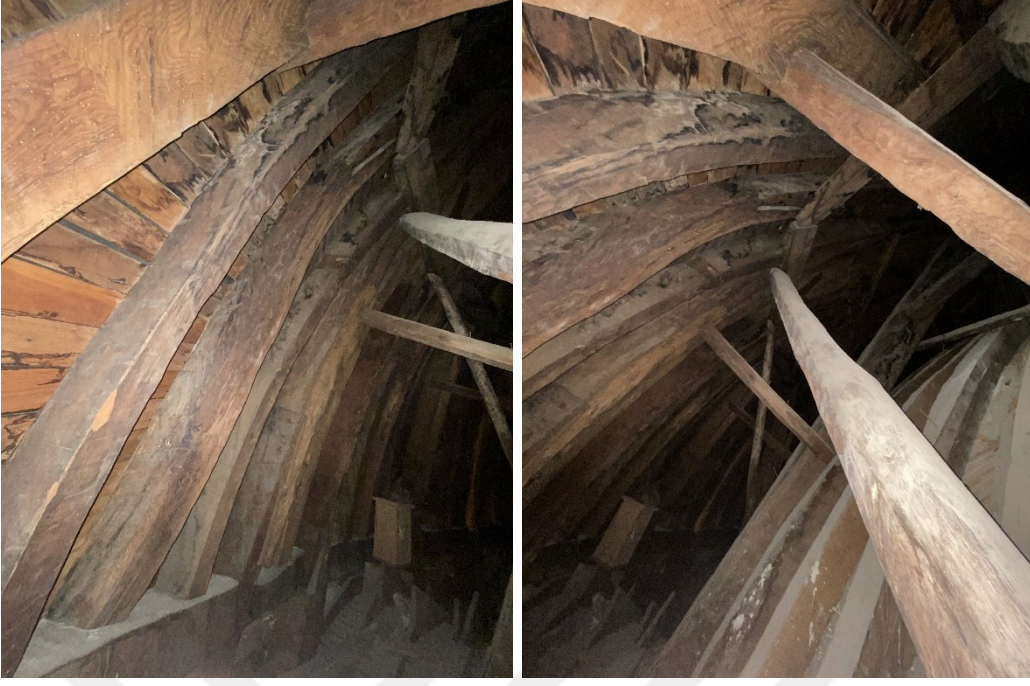
Şekil 4.6 Topkapı Sarayı Hırka-i Saadet Odası'nın kubbesinin dış cidar kaburga ve kaplamalarında görülen su lekeleri, 2021 (Kasaboğlu, E.)
