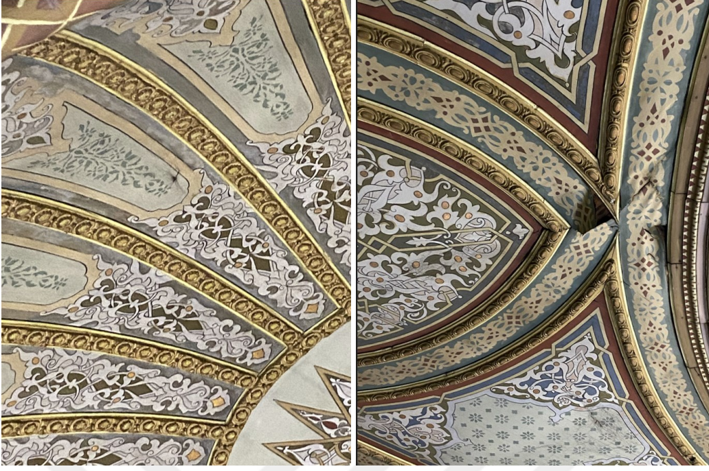
Şekil 4.18 Hasanpaşa Camisi'nin ahşap kubbesinin iç yüzeyinde görülen yağmur suyu kaynaklı bozulmalar, 2022 (Kasaboğlu, E.)
