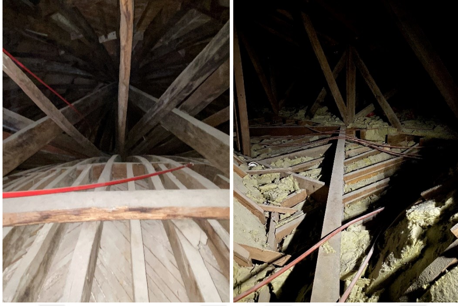
Şekil 4.30 Topkapı Sarayı Hünkâr Sofası ve Kaymak Mustafa Paşa Camisi'nin çatı arasından geçen elektrik kabloları, 2021 (Kasaboğlu, E.)
