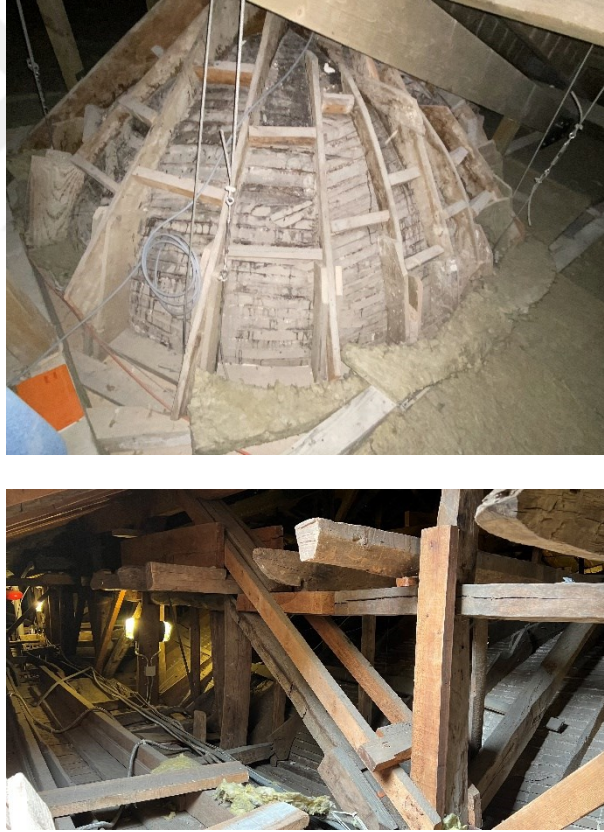
Şekil 4.31 Seyyid Nizam Camisi'nin (Kasaboğlu, E., 2021) ve Sadullah Paşa Yalısı'nın çatı arasından geçen elektrik kabloları, 2022 (TEK Esin Vakfı Doret Bardavit Arşivi)
