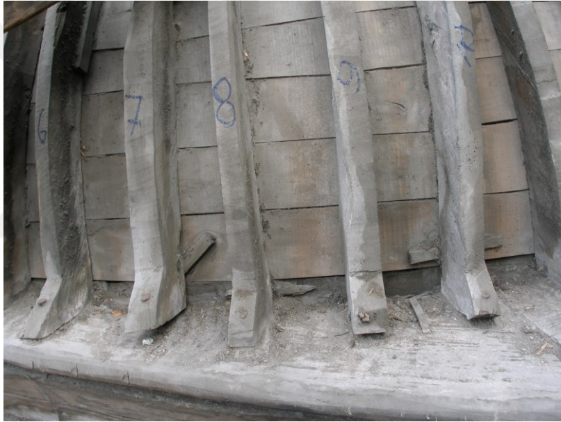
Şekil 2.129 Kaburgaların ahşap basınç çemberine ve pabuç şeklinde sonlanarak ahşap tabana çivilenmesi, restorasyon öncesi (VGM I. Bölge arşivi)
