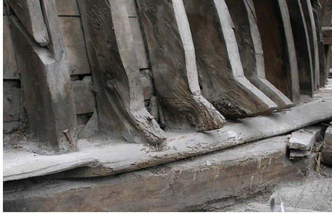
Şekil 4.2 b) Yeni Cami Hünkâr Kasrı'nın restorasyon uygulamasından önce kubbesinin kaburgalarında görülen böcek delikleri ve aşınmalar (VGM 1. Bölge Arşivi)
