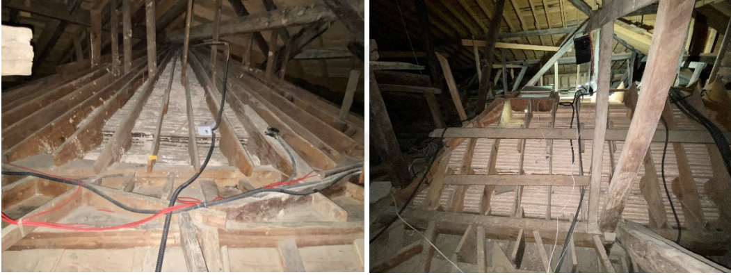
Şekil 4.27 Yahya Efendi Camisi'nin çatı arasında yer alan ahşap kubbe ve tonozun üzerinden giden elektrik kabloları, 2021 (Kasaboğlu, E.)
