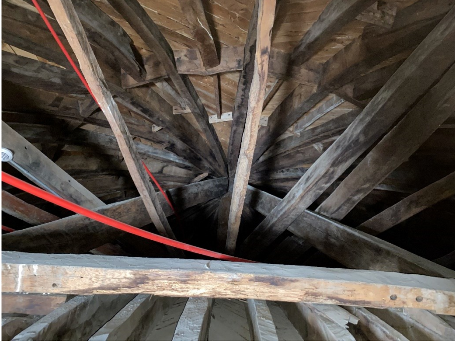
Şekil 4.7 Topkapı Sarayı Hünkâr Sofası'nın kubbesinin dış cidar kaburga ve kaplamalarında görülen renk değişimi, 2021 (Kasaboğlu, E.)
