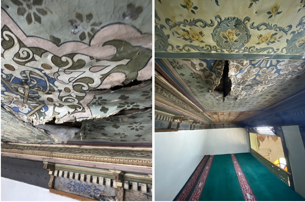
Şekil 4.19 Hasanpaşa Camisi'nin tavanındaki tekstil kaplamalarda meydana gelen bozulmalar, 2021 (Kasaboğlu, E.)
