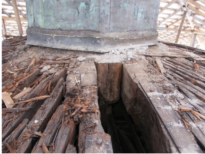
Şekil 4.10 Sadabat Camisi'nin kubbesinin alem altındaki ahşap bozulmaları, restorasyon öncesi (VGM I. Bölge Arşivi)
