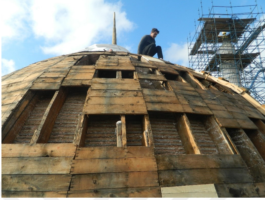
Şekil 4.13 Yıldız Hamidiye Camisi'nin kubbesinin dış yüzey ahşap kaplamalarında ve kaburgalarındaki çivilerin çevresinde oluşan renk değişimi ve sudan kaynaklı bozulmalar (VGM I. Bölge Arşivi)
