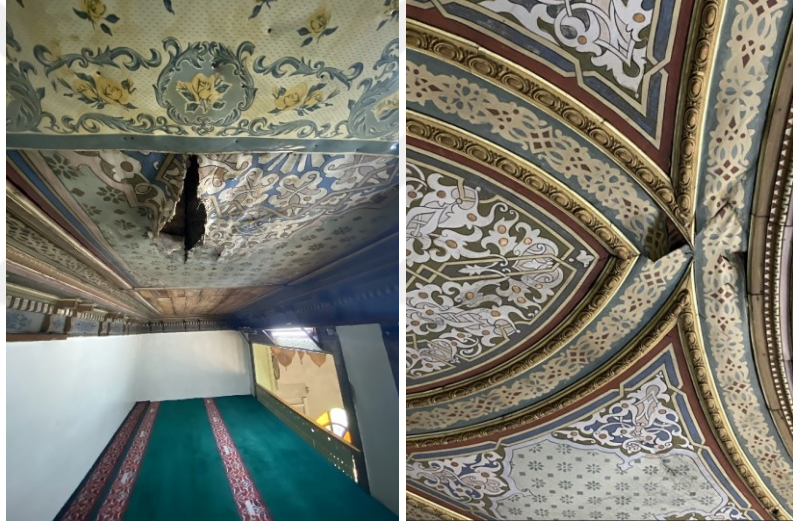
Şekil 2.383 Hasanpaşa Camisi'nin mahfil tavanında ve kubbe çevresindeki tekstilde meydana gelen bozulmalar, 2021 (Kasaboğlu, E.)
