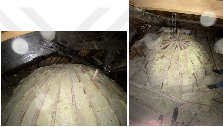
Şekil 2.235 Kaymak Mustafa Paşa Camisi'nin ahşap kubbesinin taş yünü ile kaplanmış konstrüksiyonu ve kubbenin zincirle çatıya asılması, 2021 (Kasaboğlu, E.)
