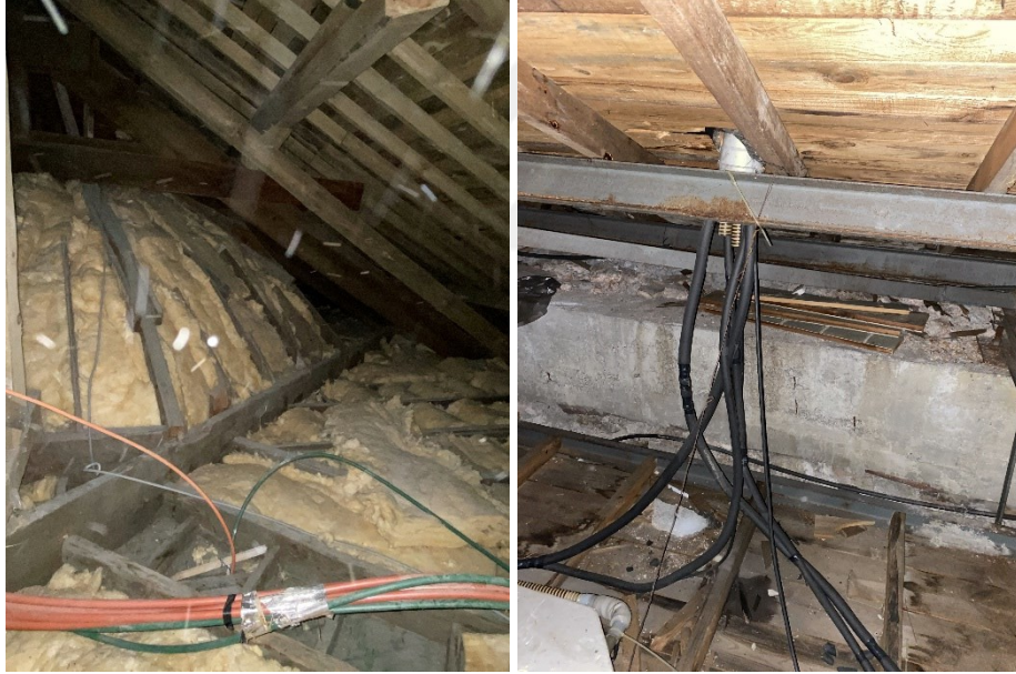
Şekil 4.29 Feneryolu Recai Yahya Camisi ve Ahrida Sinagogu'nun çatı arasından geçen elektrik kabloları, 2021 (Kasaboğlu, E.)
