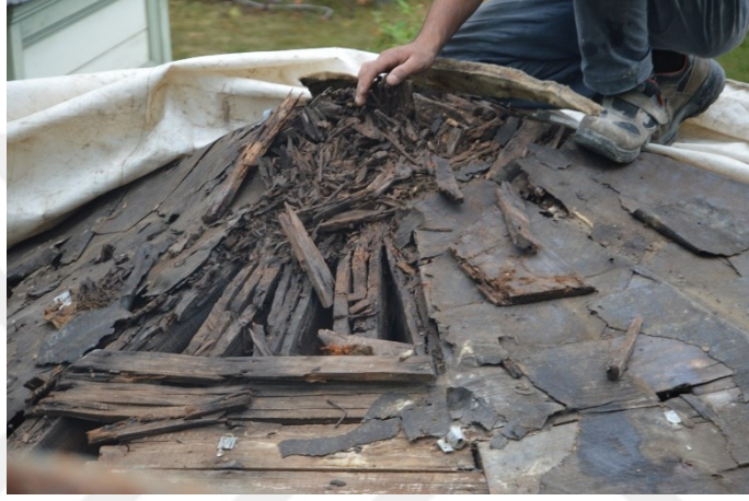
Şekil 4.9 Şeyh Zafir Türbesi'nin çatı örtüsünün tepe noktasında kurşunların birleşim yerindeki ahşap bozulmaları, restorasyon öncesi (VGM I. Bölge Arşivi)
