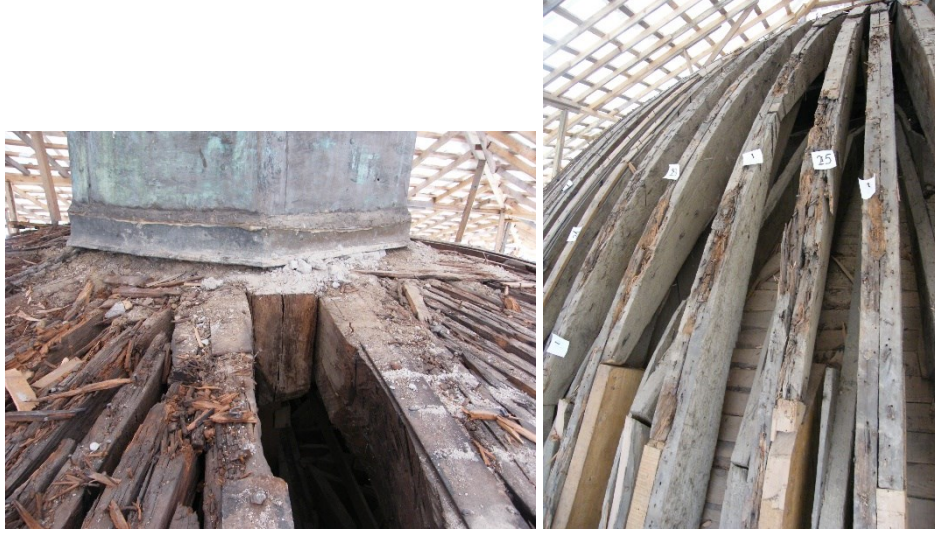
Şekil 2.207 Alem altında görülen ahşap bozulmaları ve kaburgalardaki böcek delikleri (VGM I. Bölge Arşivi)
