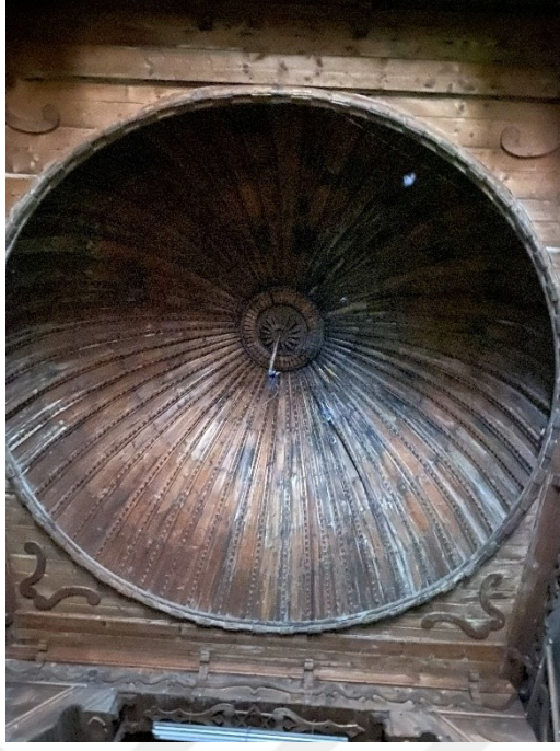
Şekil 4.8 Mayor Sinagogu’nun ahşap kubbesinin iç yüzey kaplamalarında görülen sudan kaynaklı renk değişimi ve bozulmalar, 2021 (Kasaboğlu, E.)
