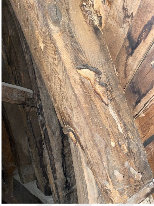
Şekil 4.1 Topkapı Sarayı Hırka-i Saadet Odası'nın kubbesinin ahşap kaburgasında mantar oluşumu, 2021 (Kasaboğlu, E.)
