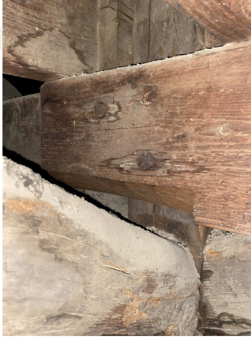
Şekil 4.14 Topkapı Sarayı Hırka-i Saadet Odası'nın kubbesinin ahşap kaburgasında çivi çevresinde oluşan renk değişimi, 2021 (Kasaboğlu, E.)
