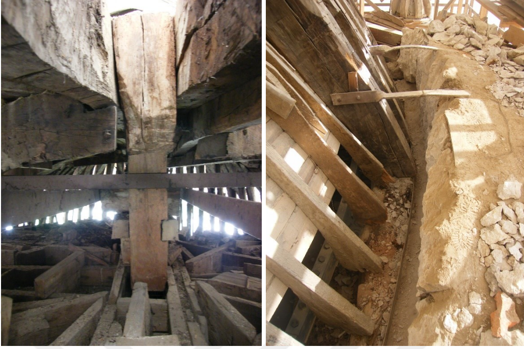
Şekil 3.49 Sadabat Camisi'nin ahşap kubbesinin dış ve iç cidarının kubbe merkezinde yer alan ahşap babada birleşimi ve kubbenin dış cidar strüktürüne sonradan eklenmiş olan metal berkitme kuşaklar (VGM I. Bölge Arşivi)
