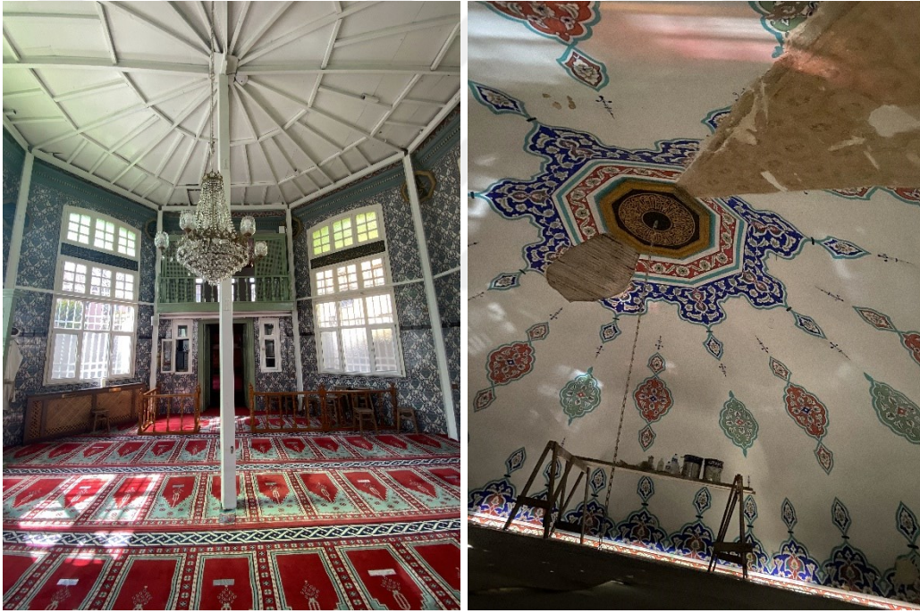
Şekil 4.22 Feridunpaşa Camisi'nin ahşap kubbesinin yüzeyinin çelik strüktür ile kapatılması ve yüzeydeki sıva dökülmeleri, 2021 (Kasaboğlu, E.)
