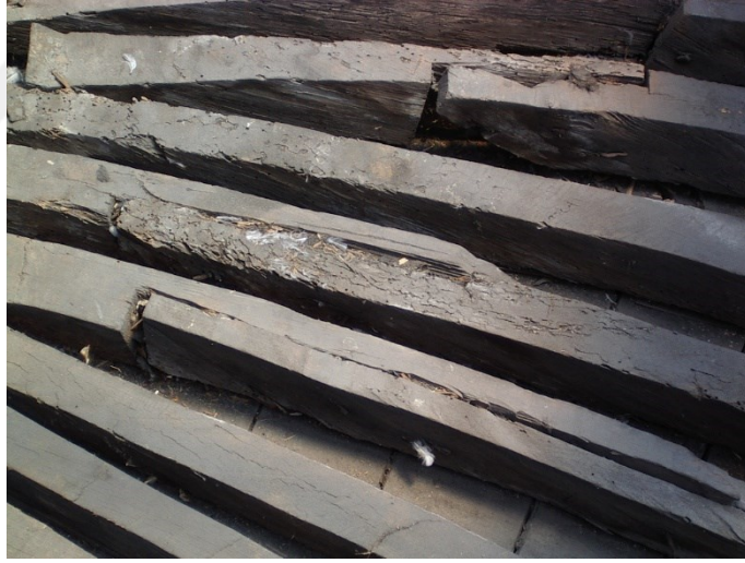
Şekil 4.2 a) Yeni Cami Hünkâr Kasrı'nın restorasyon uygulamasından önce kubbesinin kaburgalarında görülen böcek delikleri ve aşınmalar (VGM 1. Bölge Arşivi)
