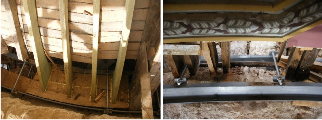
Şekil 2.204 Ahşap kubbenin tabanında yer alan özgün yatay ahşap kiriş ve restorasyon sırasında çelik çemberlerin eklenmesi (VGM I. Bölge Arşivi)
