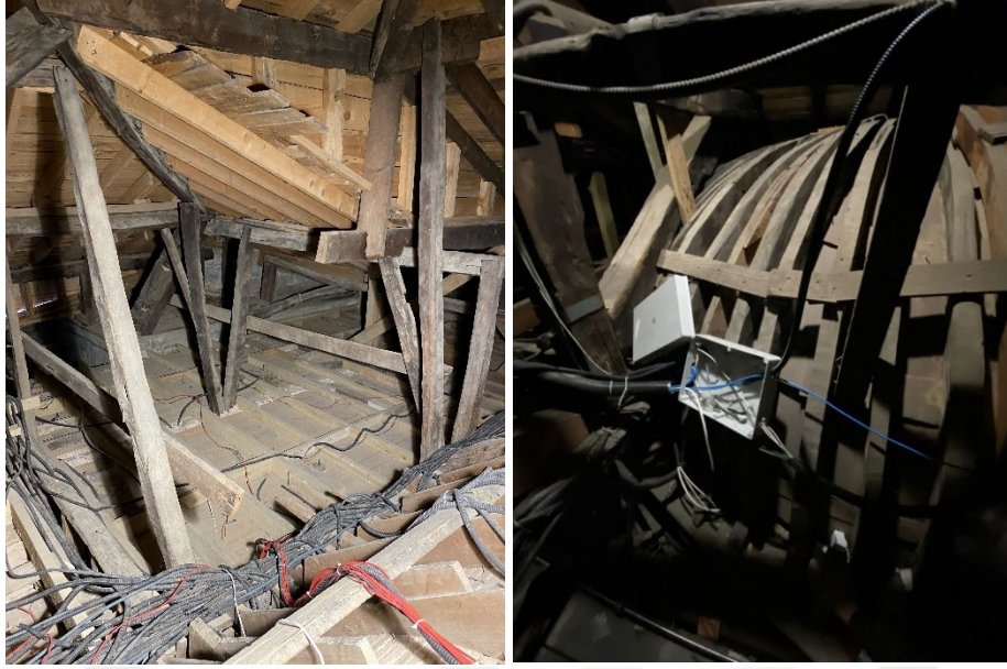
Şekil 4.28 Yahya Efendi Camisi'nin ve Yeni Cami Hünkâr Kasrı'nın çatı arasında dağınık şekilde elektrik kabloları, 2021 (Kasaboğlu, E.)
