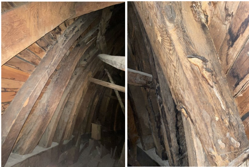
Şekil 2.54 Dış cidarın ahşap kaburga ve kaplamalarında görülen renk değişimleri ve mantar oluşumu 2021 (Kasaboğlu, E.)
