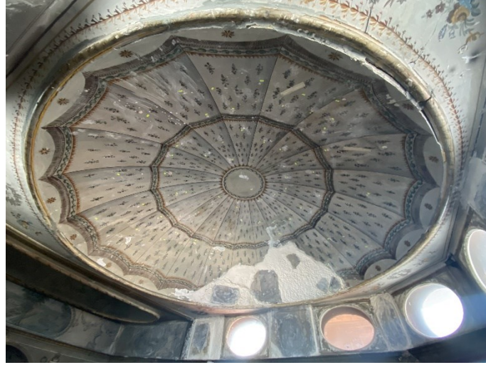
Şekil 4.21 Topkapı Sarayı III. Ahmed Köşkü'nün ahşap kubbesinin iç yüzeyindeki sıva dökülmeleri, 2021 (Kasaboğlu, E.)
